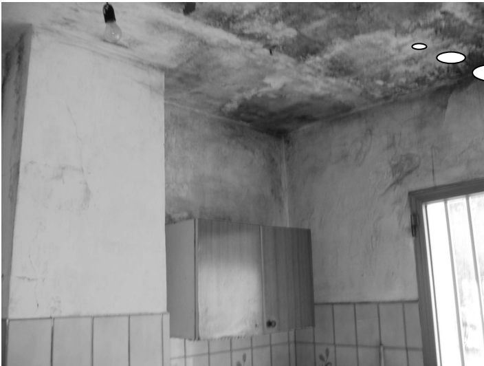
PATOLOGIE EDILIZIA messa in evidenza dei profili di umidità
