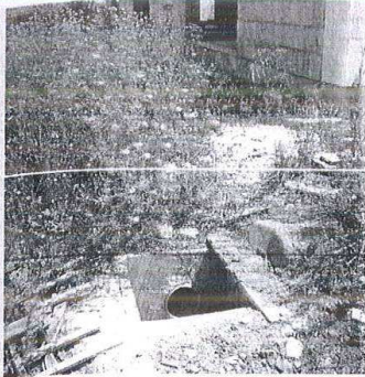
Foto n° 11 - Particolare impianto smaltimento reflui
