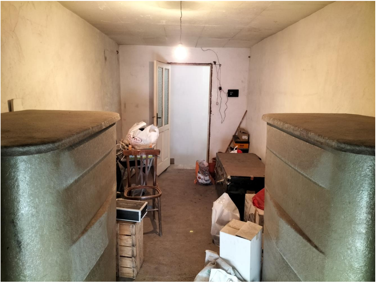
Riserva idrica al piano ammezzato.
