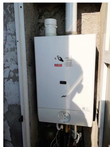
Caldaia esterna per ACS
