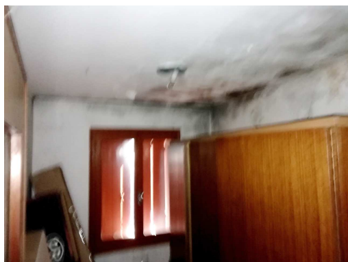
Stanzino al piano secondo con segni di degrado per umidità
