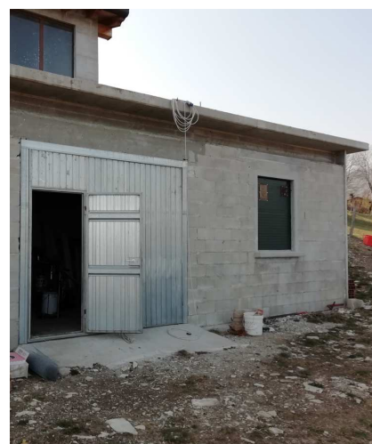
Vista est – locali abusivi
