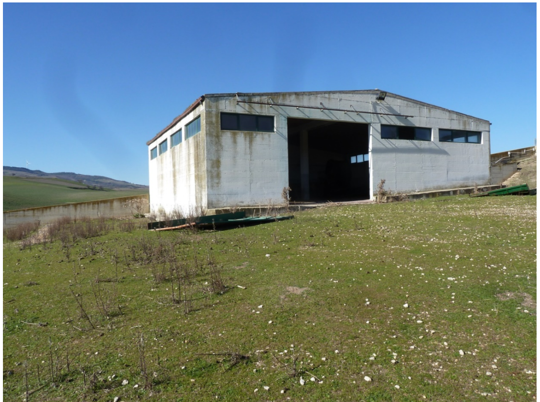
FOTO 8 – Visione dello stesso corpo di fabbrica della foto 7 identificato nel catasto fabbricati come p.lla 361 sub 1 del fg 4. Non è in regola con gli strumenti urbanistici
