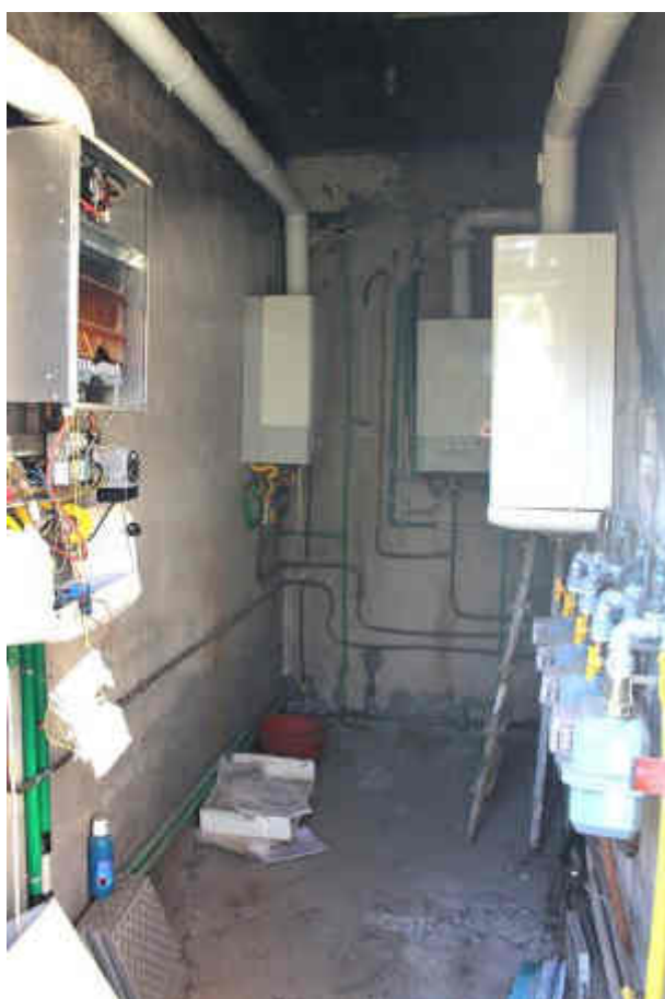
Foto 72 – il Locale Tecnico dei Sub. 1 – 2 – 3 e 4
