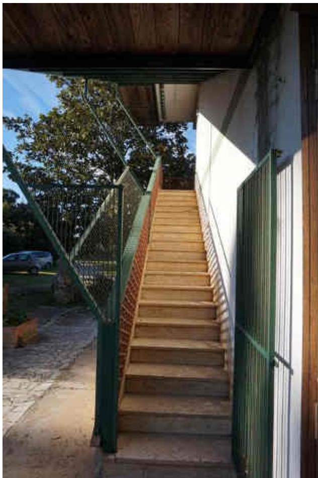
Foto 39 – la Scala di accesso al Balcone/ Ballatoio, su cui si affacciano gli ingressi dei Sub. 3 e Sub.4 posti al Piano Primo
