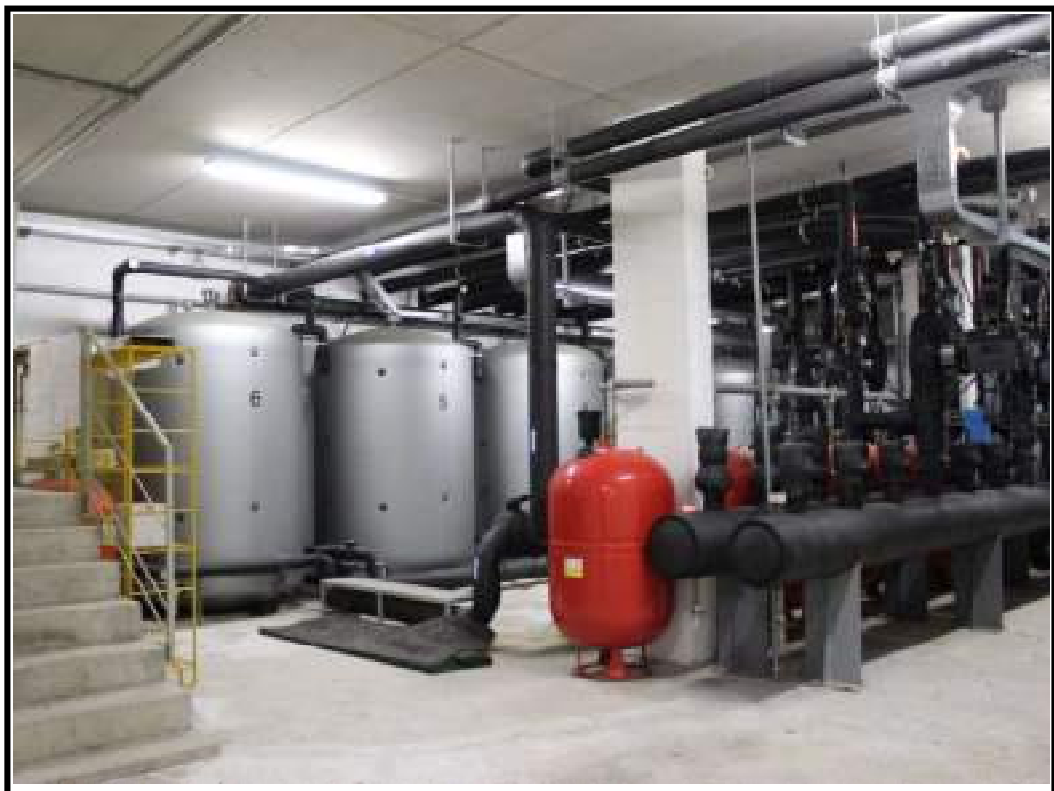
Foto 28 Locale interrato per gestione climatizzazione
