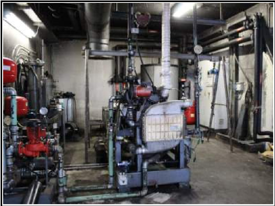
Foto 33 Impianto di cogenerazione
