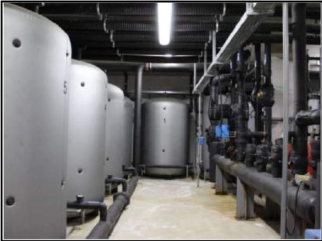
Foto 29 Locale interrato per gestione climatizzazione
