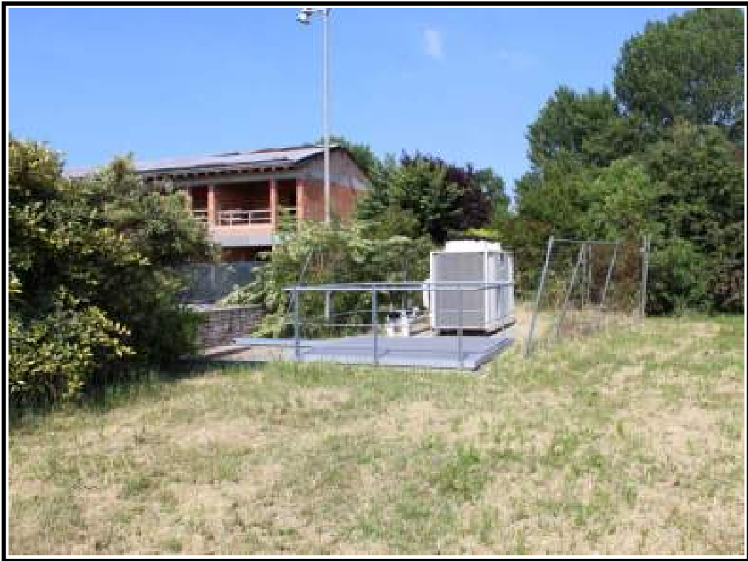
Foto 27 Accesso ai locali tecnici interrati
