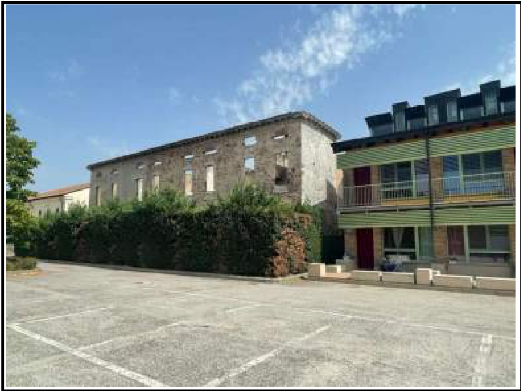
Foto 15 Prospetto fabbricato collabente (Mapp. 129)
