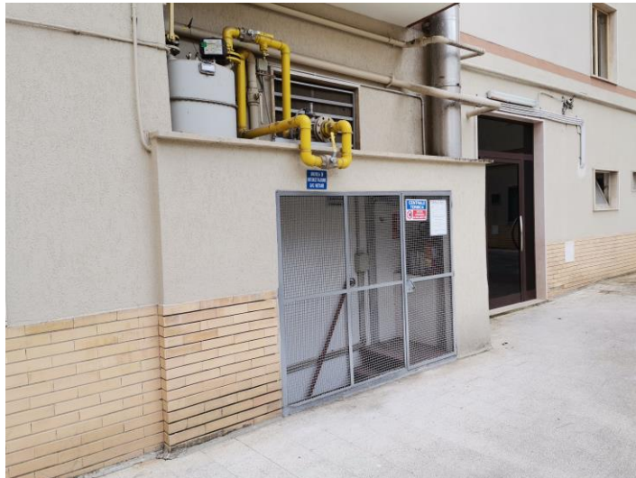
La centrale termica
