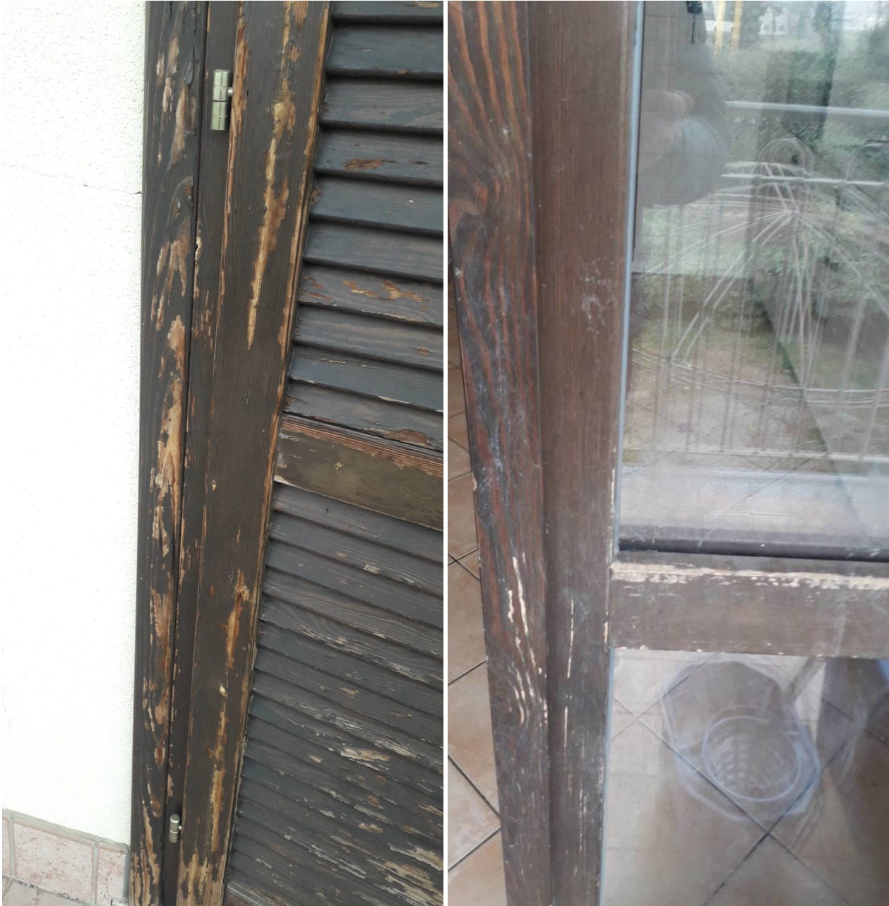
Particolare di alcuni infissi esterni degradati
