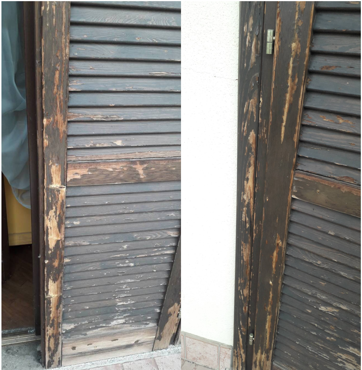
Particolare di alcuni infissi esterni degradati
