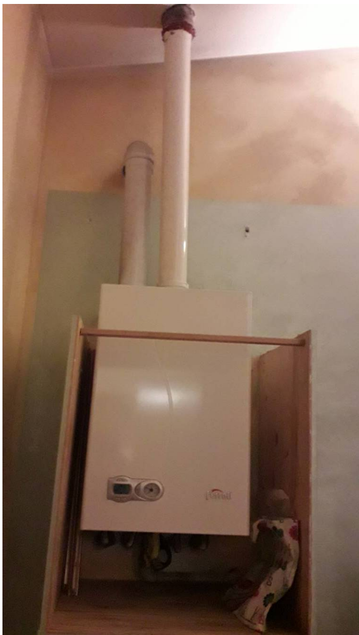
Alloggiamento caldaia al piano secondo nel disimpegno
