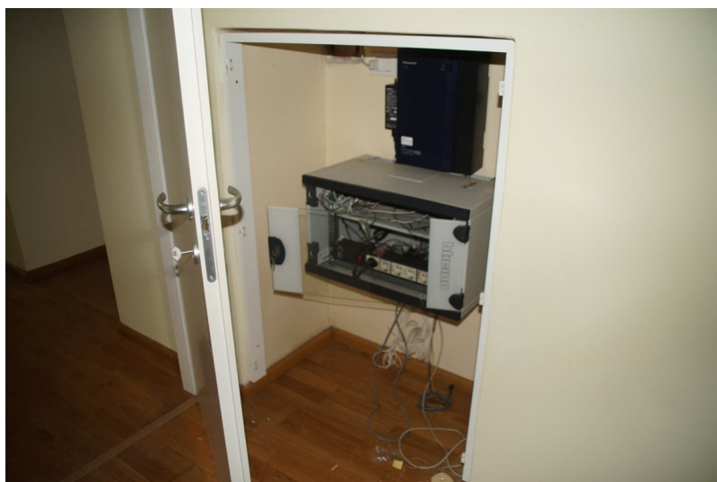
Foto n°16: altro particolare dell'ufficio posto frontalmente alla zona d'attesa, si noti la presenza di una piccola nicchia che ospita il quadro elettrico anch'essa non inserita nella planimetria.
