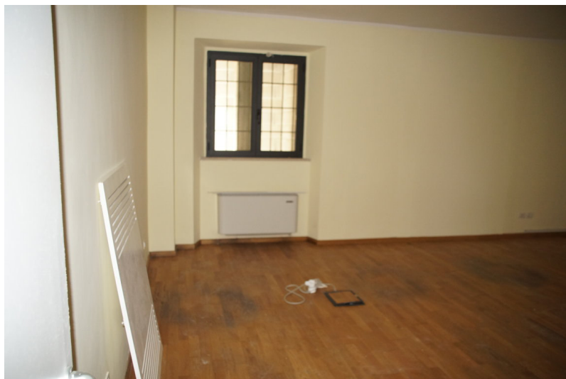
Foto n°14: particolare del locale ad uso ufficio posto frontalmente alla zona d'attesa, si noti la presenza di ventilconvettori.
