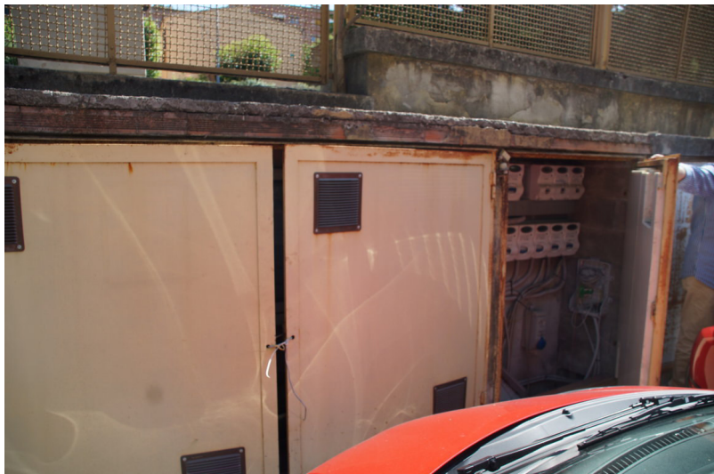
Foto n°10: particolare dell'alloggiamento dei contatori della luce.
