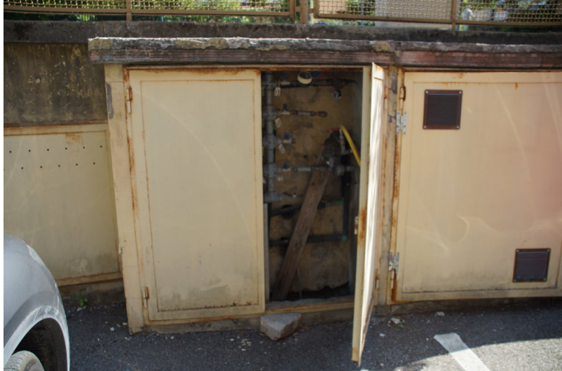
Foto n°9: particolare dell'alloggiamento dei contatori dell'acqua.
