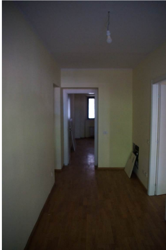
Foto n°13: particolare interno dell'ingresso si notino le pareti intonacate e tinteggiate dai colori pastello e la copertura del pavimento in laminato.
