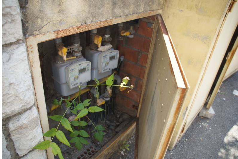
Foto n°11: particolare dell'alloggiamento dei contatori del gas.
