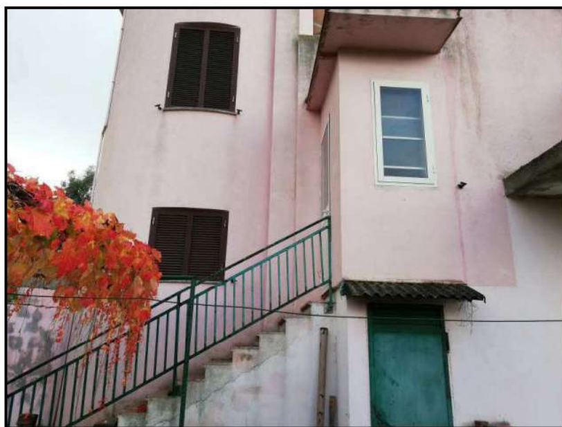
Foto 28 – Scale ingresso lato nord locale cucina (piano terra porta locale caldaia)
