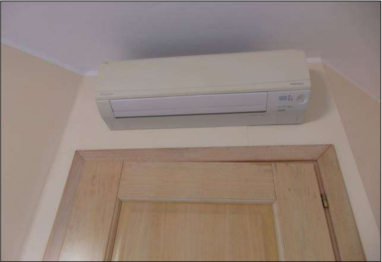
Foto n° 41 – Tipologia unità interna PdiC.
