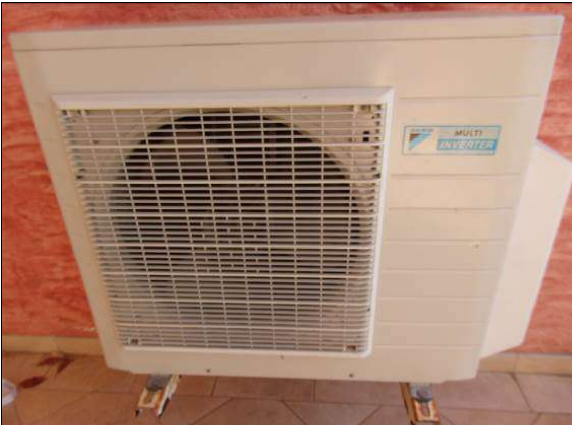
Foto n° 40 – Tipologia unità esterna PdiC (Trial).
