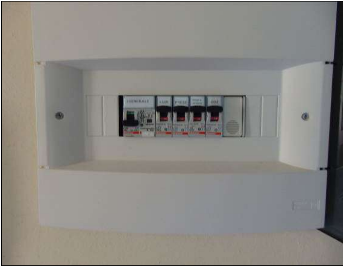
Foto n° 37 – Tipologia quadro elettrico.
