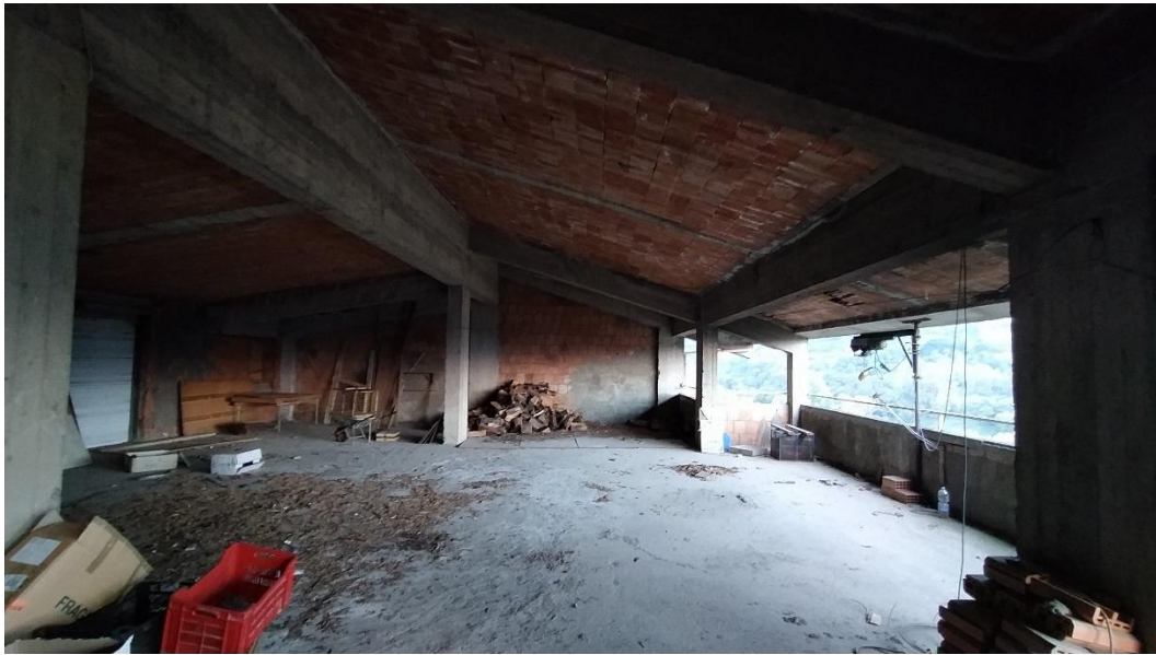
Foto 4: Catasto Fabbricati di Sant'Eufemia d'A., foglio 3, particella 475 sub 11, Corso Umberto I. Appartamento in corso di costruzione.
