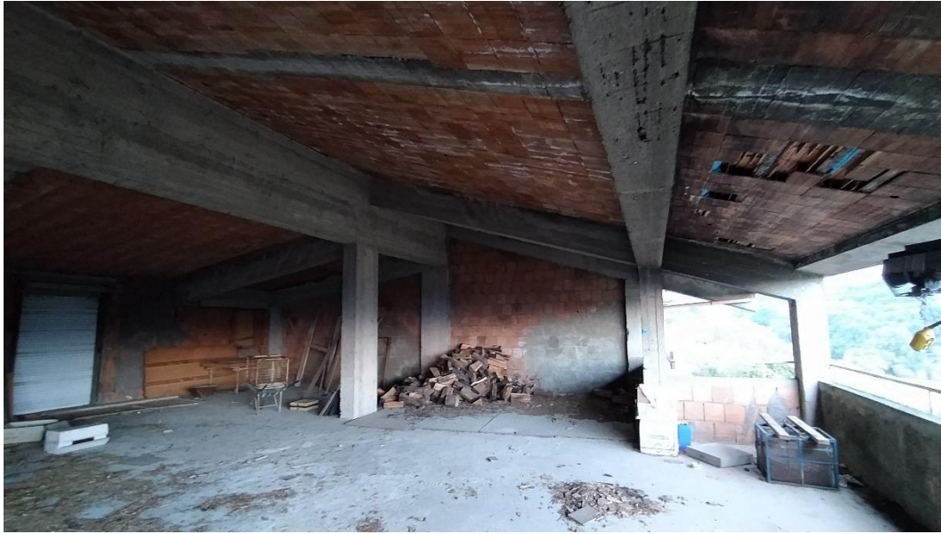
Foto 3: Catasto Fabbricati di Sant'Eufemia d'A., foglio 3, particella 475 sub 11, Corso Umberto I. Appartamento in corso di costruzione.
