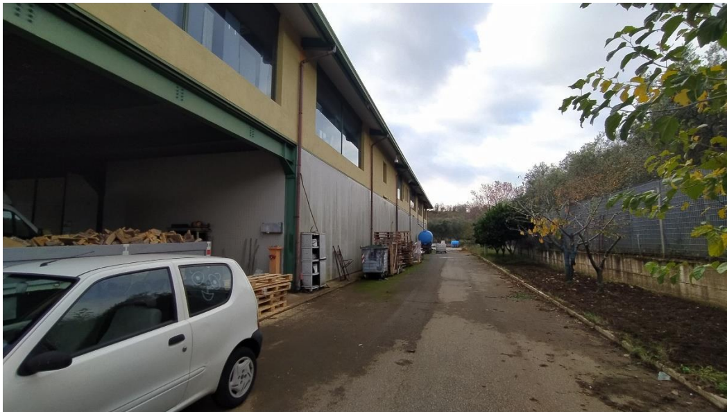
Foto 2: lato nord del capannone; sulla sinistra si vede il portico antistante al deposito presente al piano terra.
