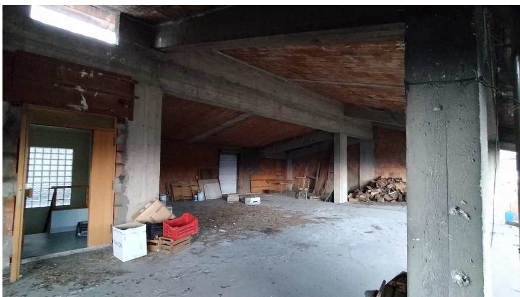
Foto 2: Catasto Fabbricati di Sant'Eufemia d'A., foglio 3, particella 475 sub 11, Corso Umberto I. Appartamento in corso di costruzione.
