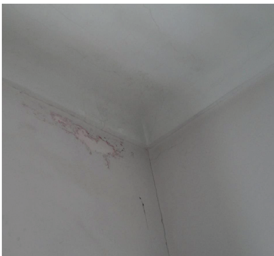
foto 14_ particolare del degrado sulle pareti e soffitto
