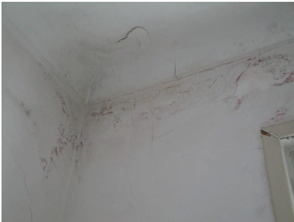
foto 13_ particolare del degrado sulle pareti e soffitto
