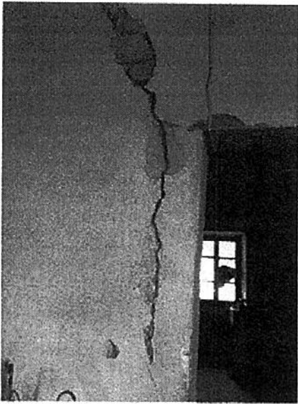
Foto 31 – Particolare delle fessurazioni
