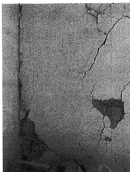
Foto 30 - Particolare delle fessurazioni
