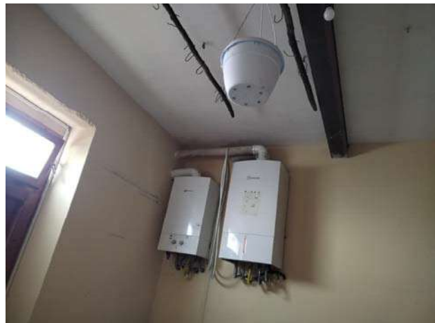
P.T. cantina: vista delle caldaie
