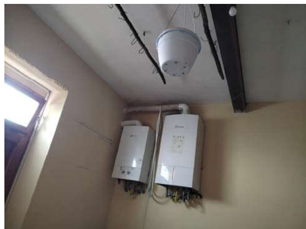
P.T. cantina: vista delle caldaie
