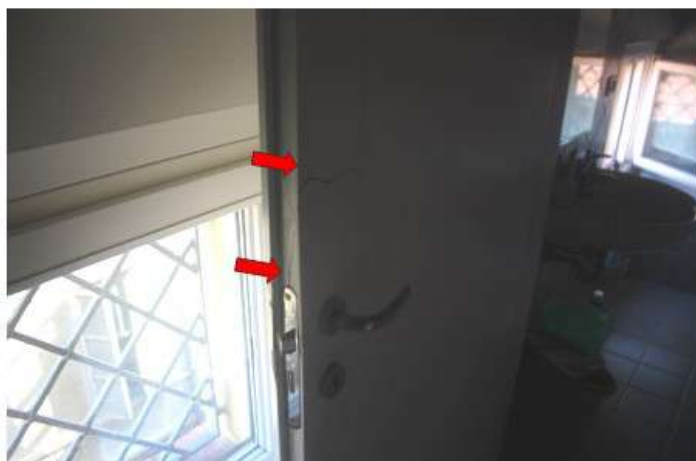
Foto 5-I: rottura nella porta di ingresso al bagno 2
