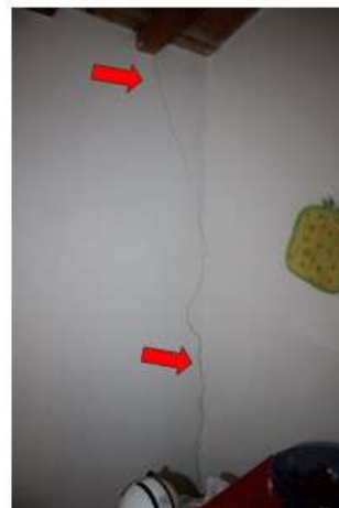
Foto 5-L: lesione muraria subverticale
