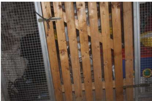
Foto 2-H: ingresso alla cantina e parete in rete metallica
