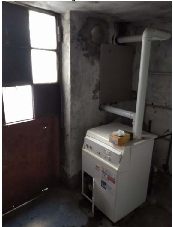
Immagine 12 - Locale caldaia
