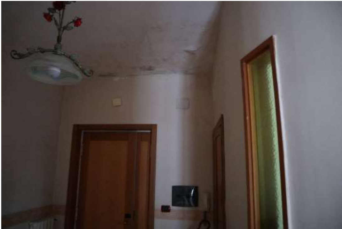
INGRESSO (CON TRACCE DI INFILTRAZIONI AL SOFFITTO)
