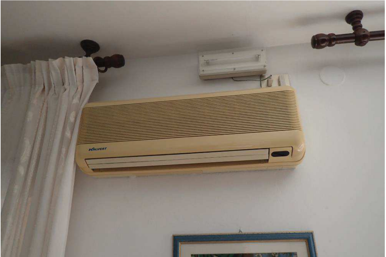
Foto 33 - Split impianto di condizionamento
