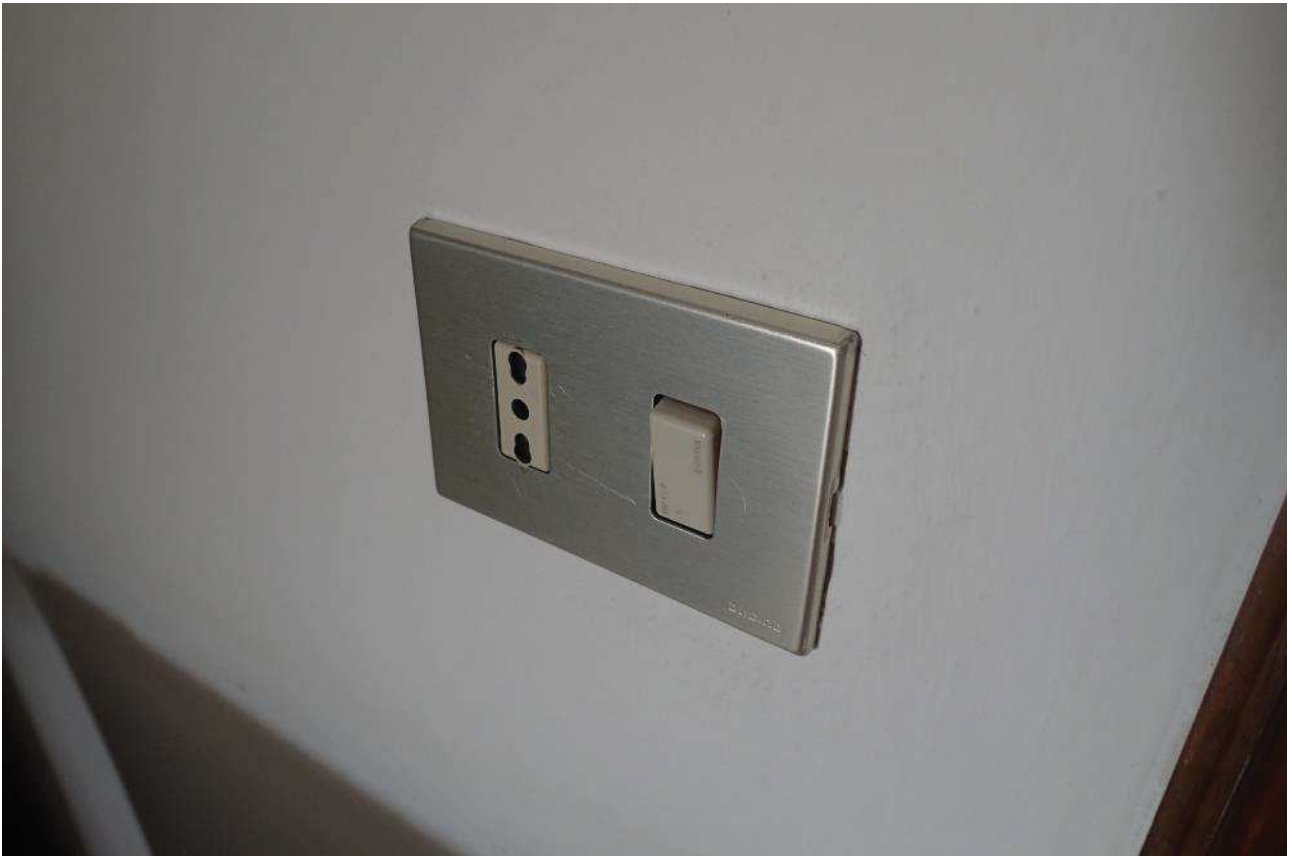
Foto 34 - Particolare impianto elettrico
