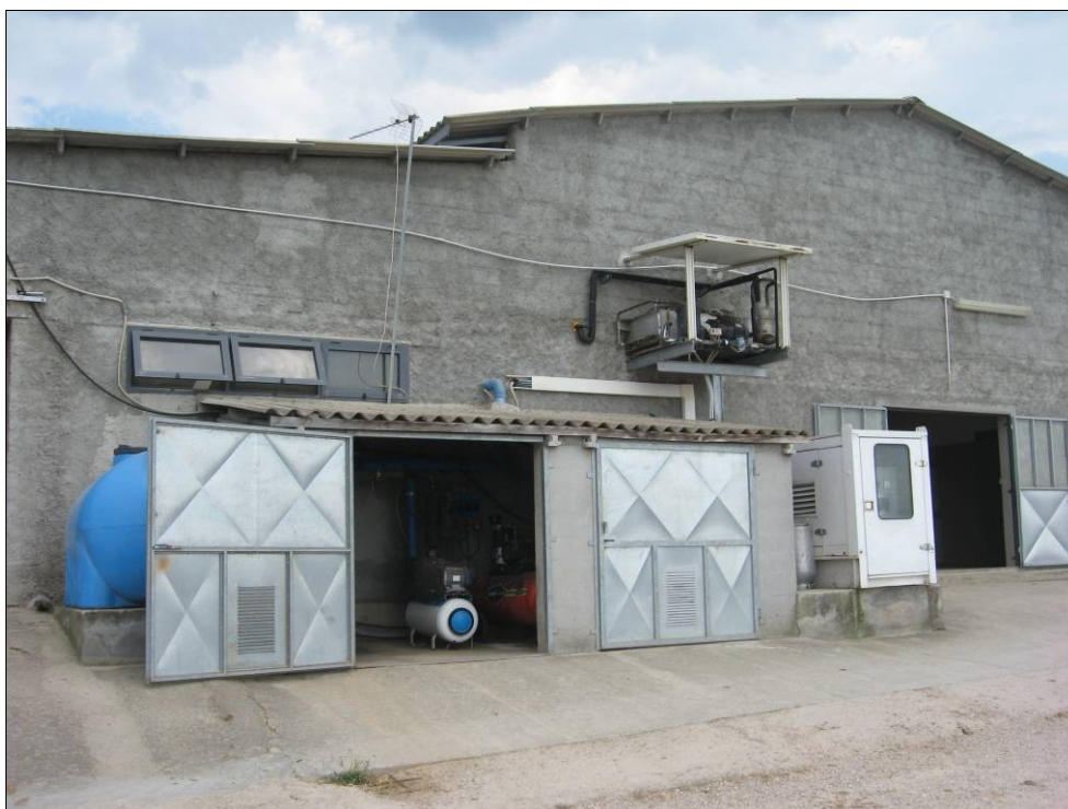
FOTO 11 – Uno dei locali tecnici posto sul fronte principale della stalla. La finestra si apre sul locale destinato alla sorveglianza dell'impianto.
