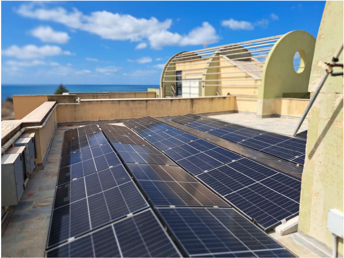
Foto n. 17 – Impianto fotovoltaico condominiale posto sui lastrici solari del fabbricato
