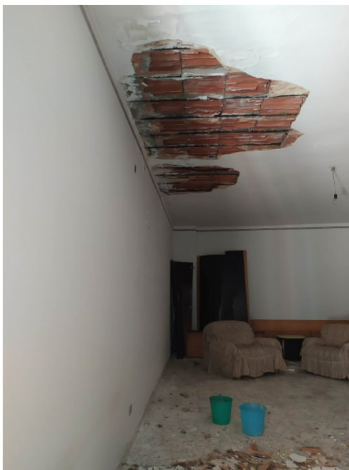
Sfondellamento del solaio del salone
