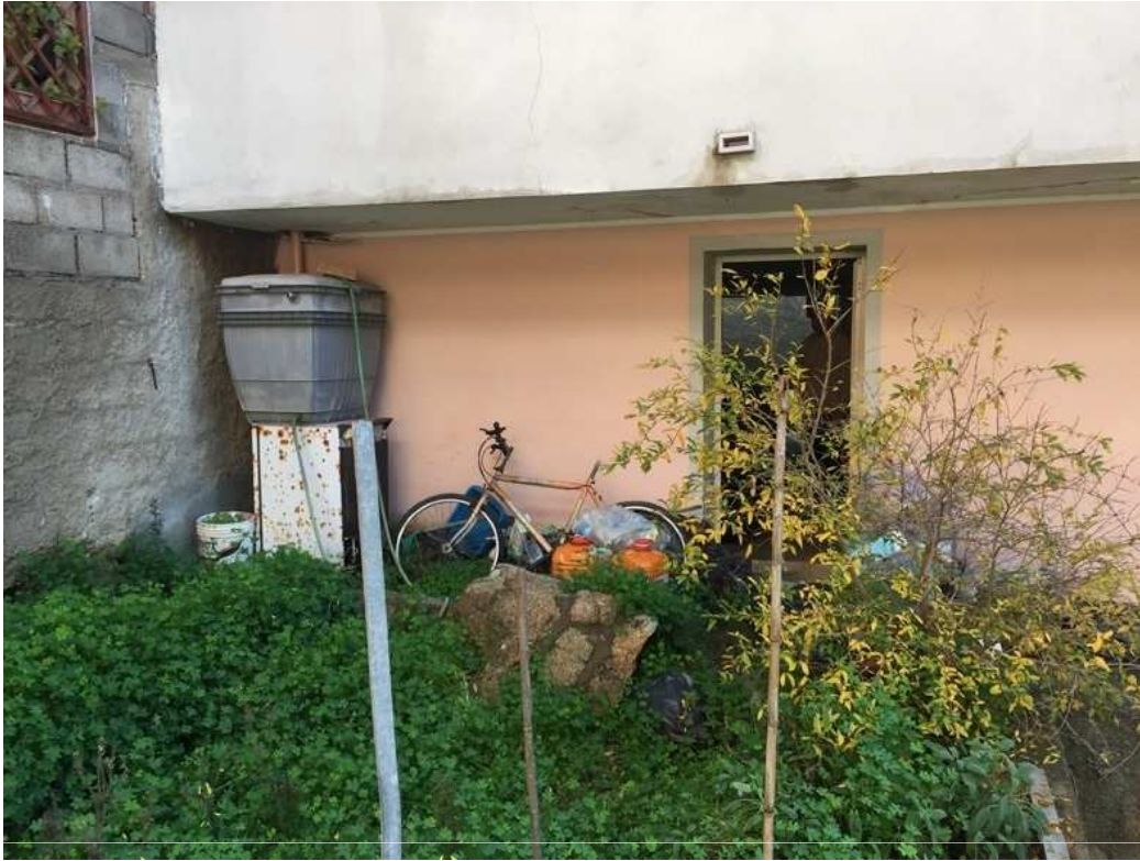
Foto 55. Vista sul retro del magazzino e sull'apertura abusiva
