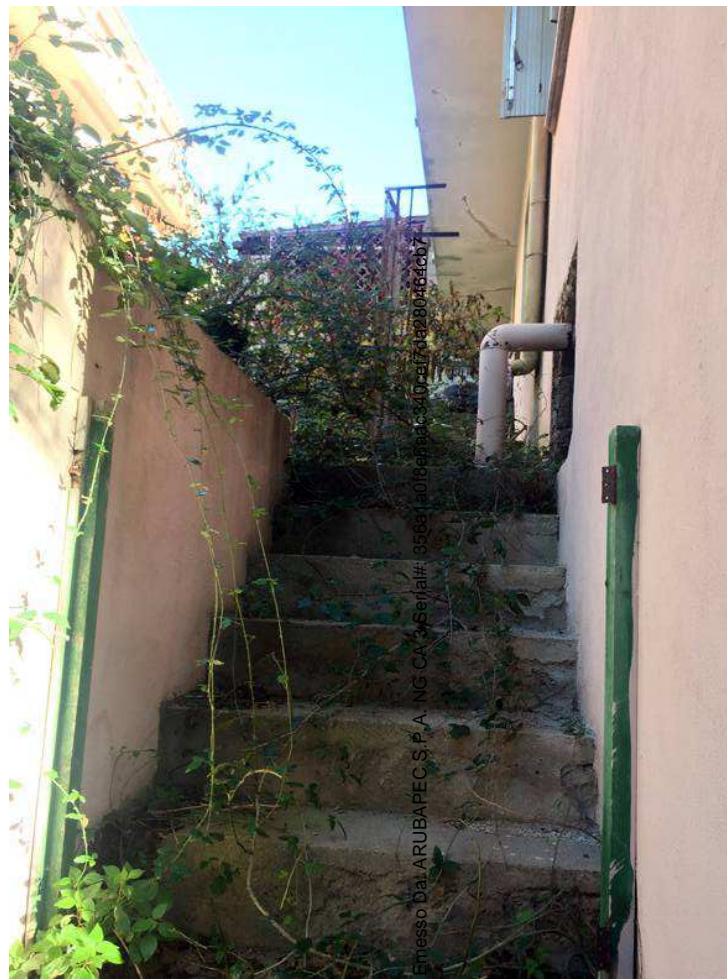
Foto 13. Scalinata non concessionata, a nord - ovest
