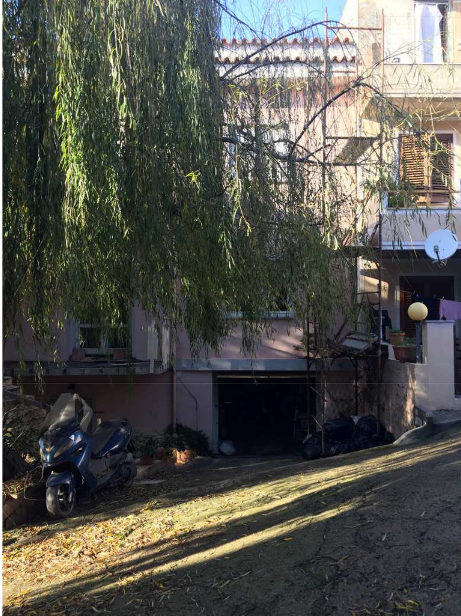
Foto 2a. Prospetto principale con la parete laterale in aderenza ad un altro fabbricato
