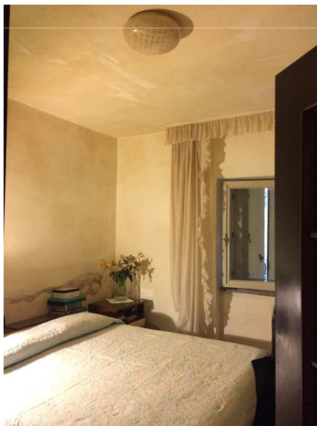
Foto 43-44. (Sub4) Camera matrimoniale, umidità di risalita proveniente dal magazzino
