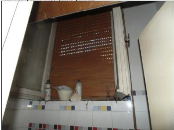
Foto n. 05: Interno W.C. - parete ffinestrata
