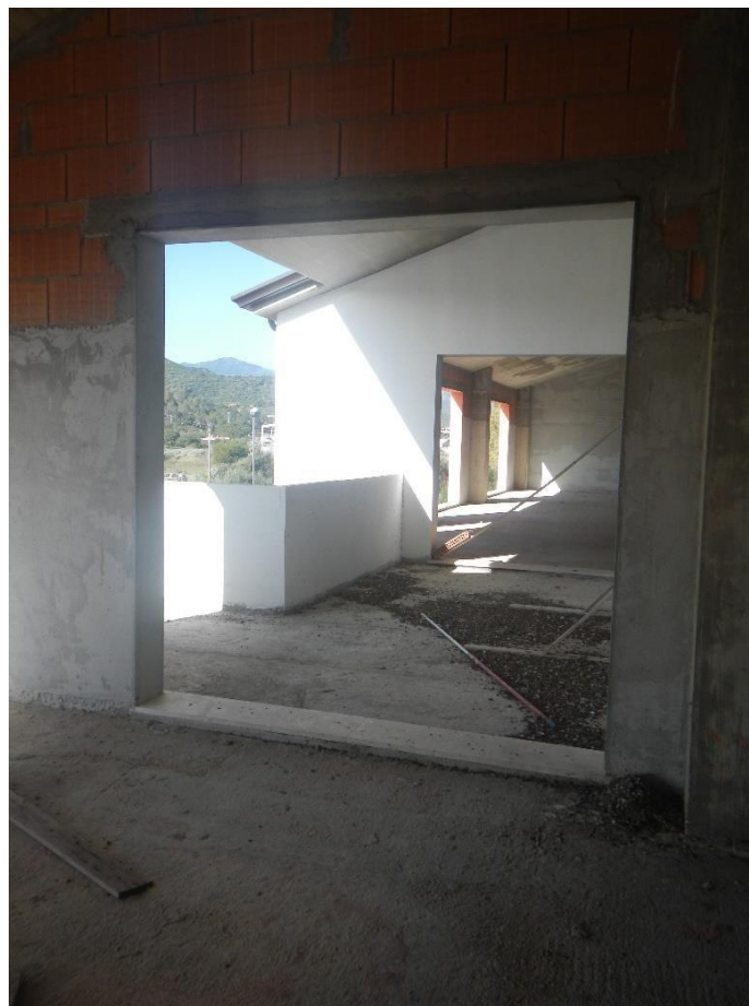
Foto 25: dettaglio aperture lato nord (difformi)
