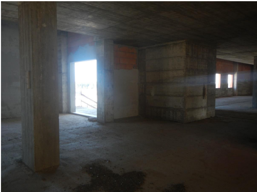
Foto 21: aperture lato nord (difformi)
