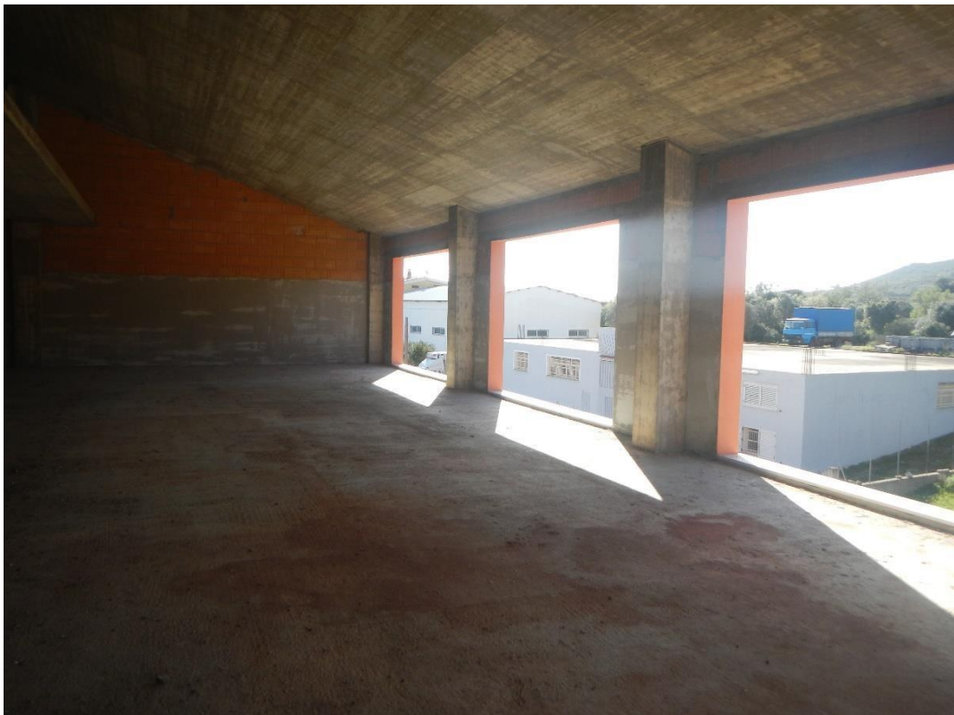
Foto 23: Parete finestrata ancora priva di infissi (lato Nord)
