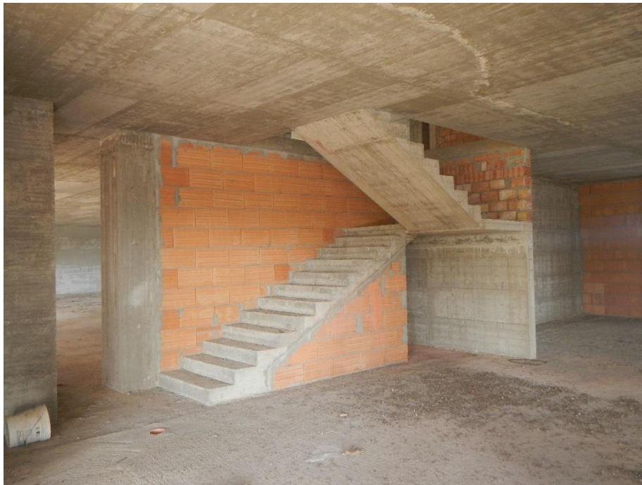
Foto 26: Scala interna per accesso a soppalco (difforme)
