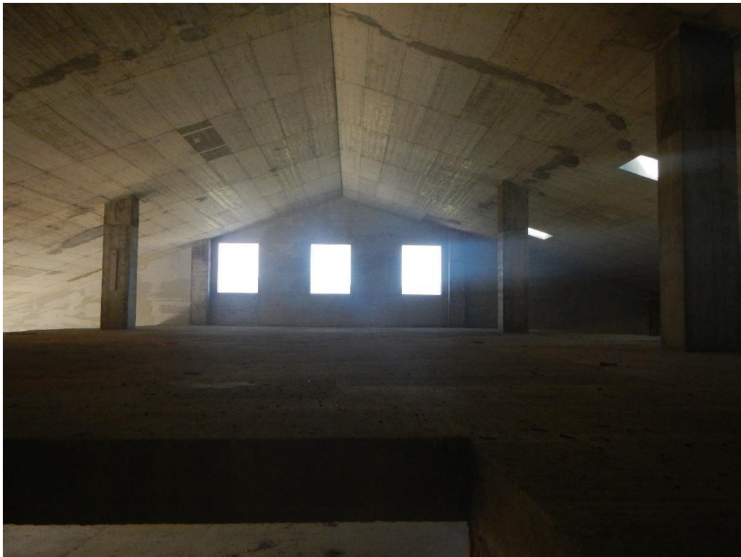
Foto 18: Soppalco finestrato (dettaglio tetto a falda difforme)
