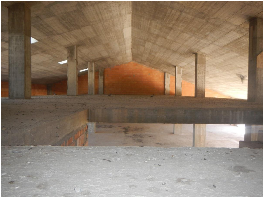
Foto 17: Soppalco (dettaglio tetto a falda difforme)
