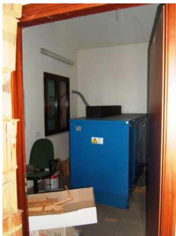
Foto n. 25: Lotto 2– Locale impianti
