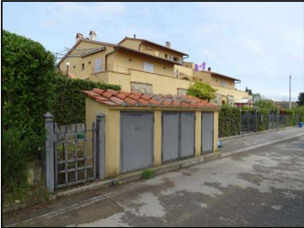
FOTO 3 CONTATORI GAS A SERVIZIO DELLE UNITA' IMMOBILIARI
