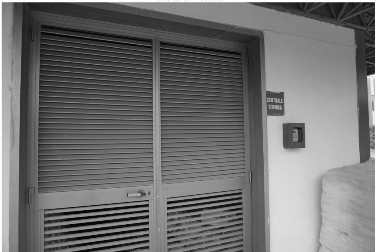
foto n. 16 – locale centrale termica
