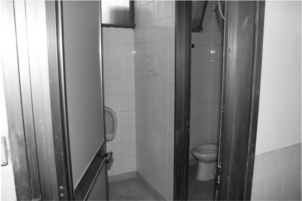
foto n. 25 – interno locale (parte abusiva)
