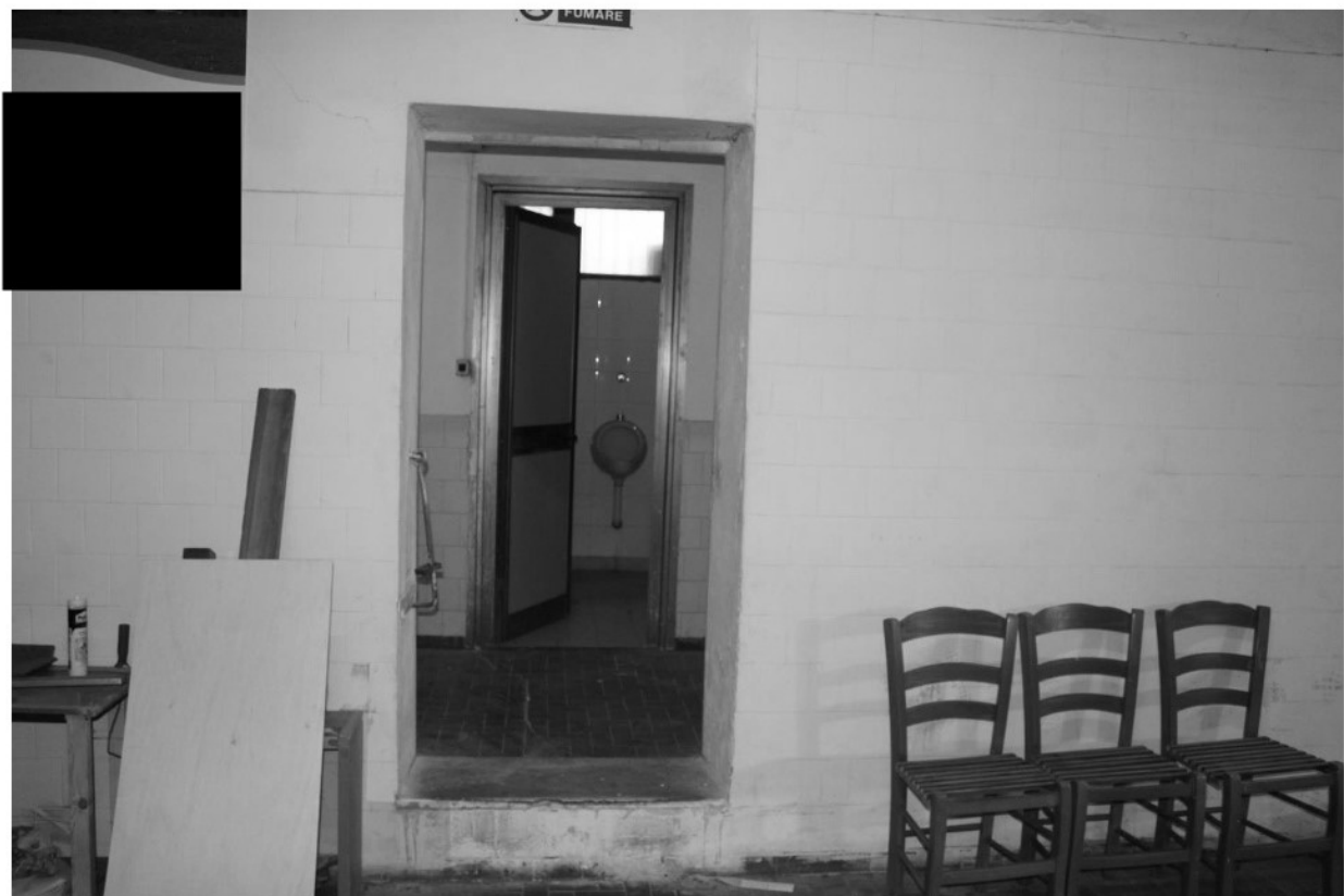
foto n. 26 – interno locale (parte abusiva)
