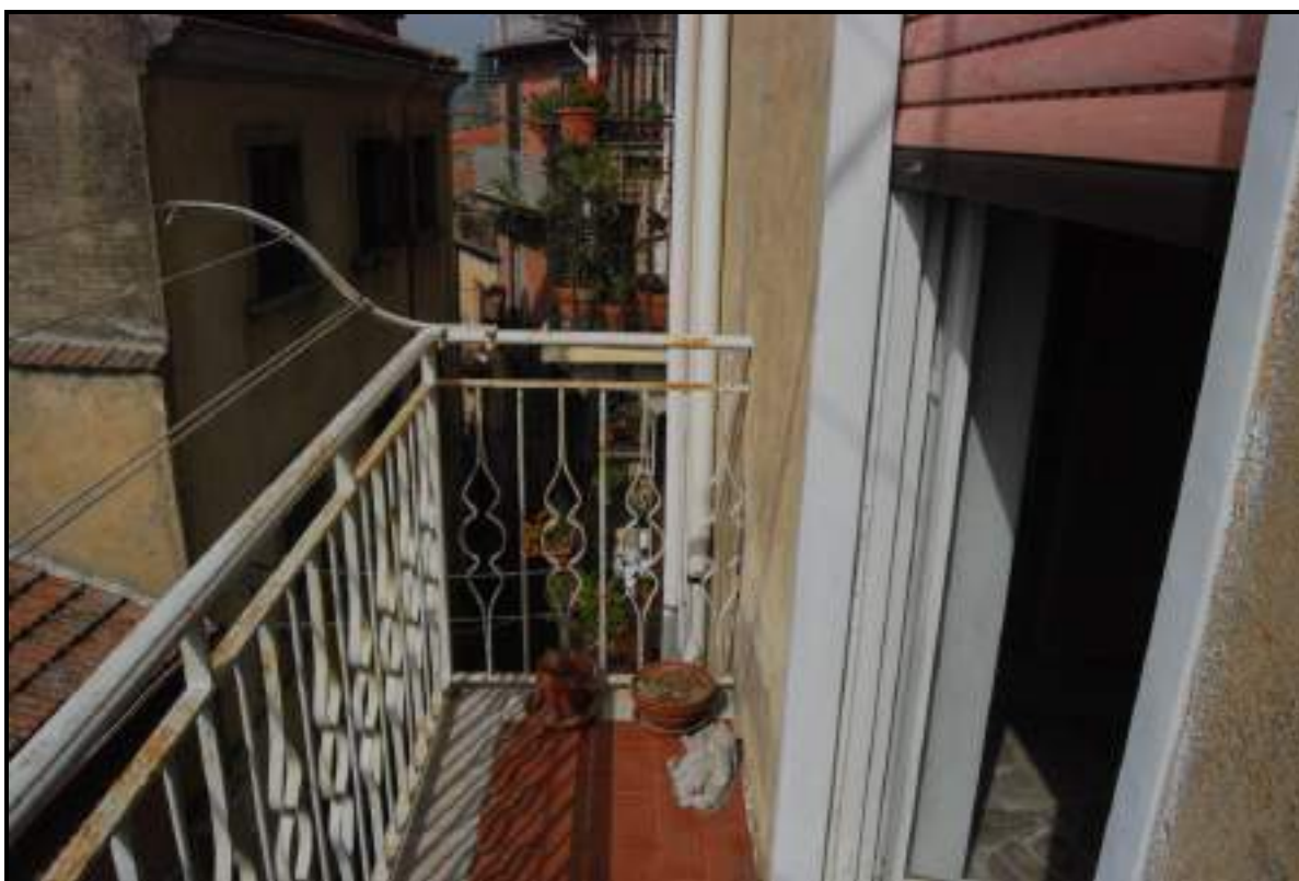
FOTO 35 – Nicosia - Foglio 82/I – Particelle 2467 – Sub. 2 – Piano primo – Balcone esterno su Via Giuseppe Fontana
