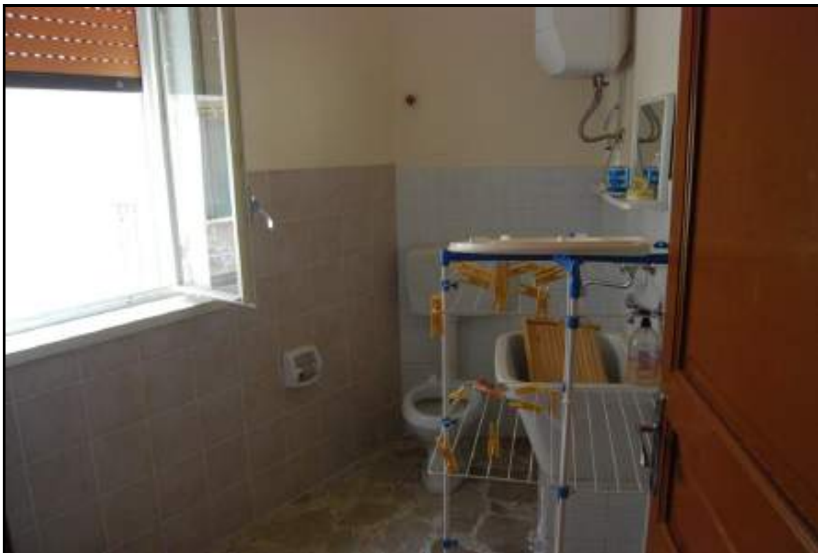
FOTO 34 – Nicosia - Foglio 82/I – Particelle 2467 – Sub. 2 – Piano primo – Lavanderia
