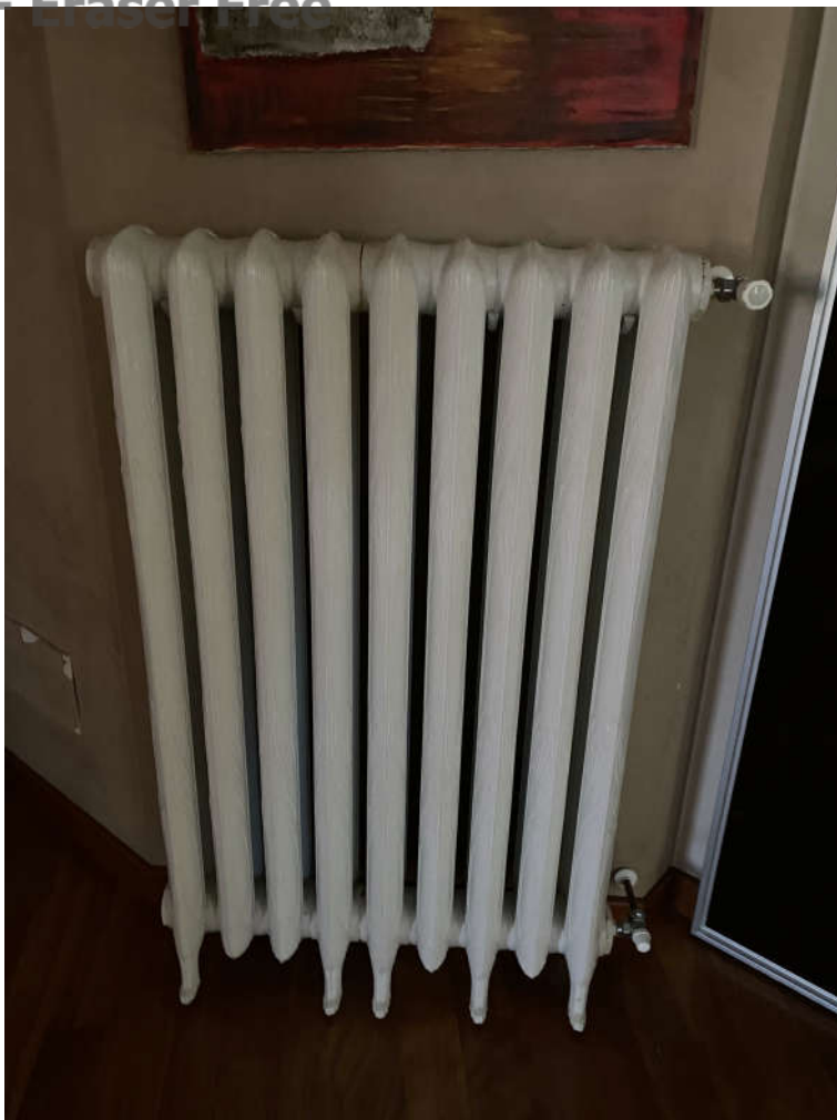
Foto 21 - particolare impianto riscaldamento
