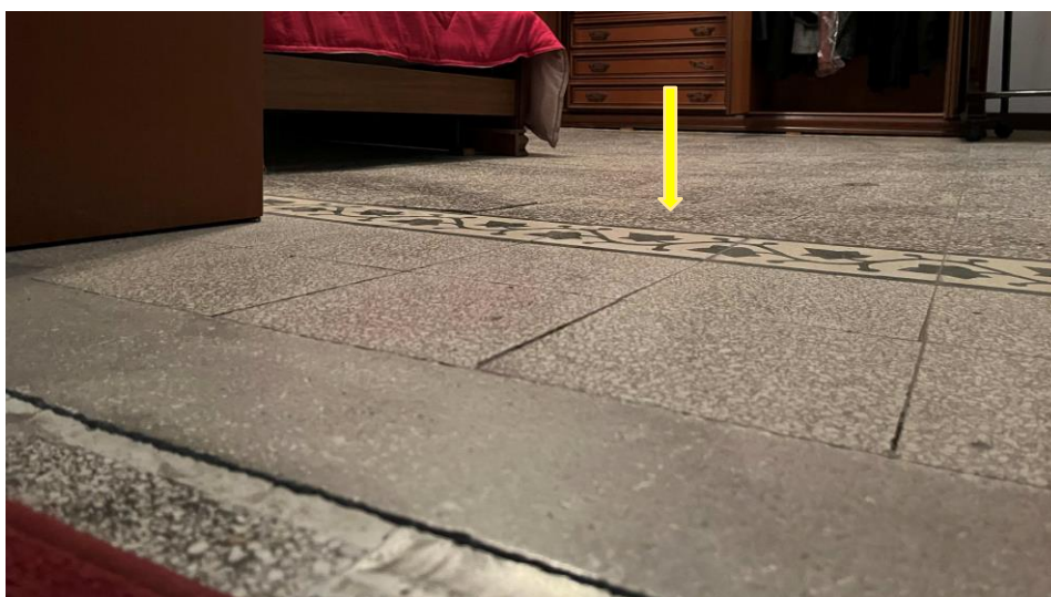
FOTO 12. Particolare del pavimento della camera da letto al primo piano, con riferimento al cedimento
