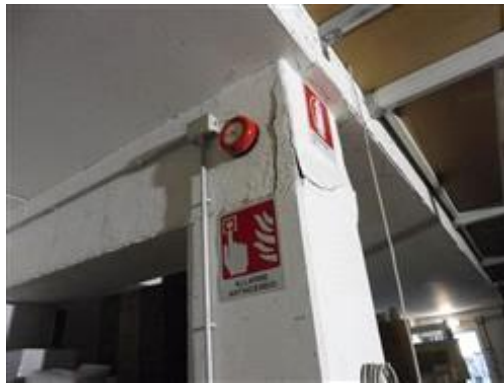
Lesione nodo pilastro-trave
