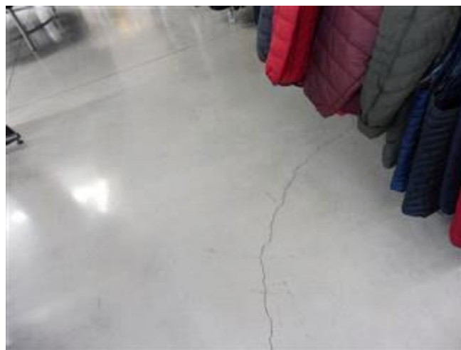
lesione interna a pavimento
