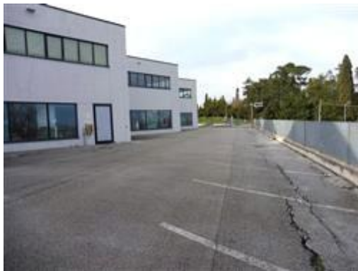
lesioni lato Est
