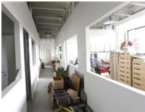
zona uffici incompleta
