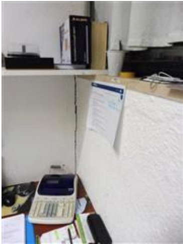
Zona uffici - distacco divisorio da parete esterna
