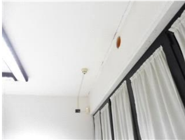
Fessurazione sul solaio interpiano in corrispondenza del collegamento con parete esterna
