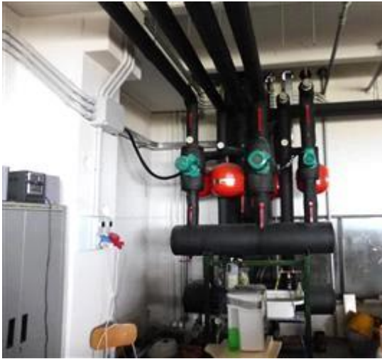
tubazioni impianto termico da copertura ai piani inferiori
