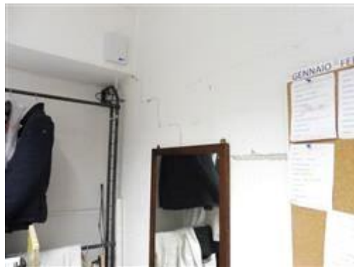
Lesione del divisorio non strutturale
