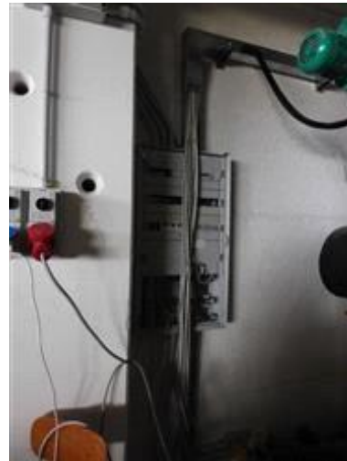
quadro elettrico di zona incompleto
