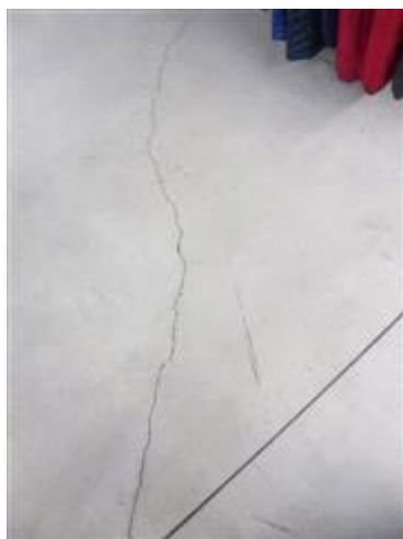
lesione interna a pavimento
