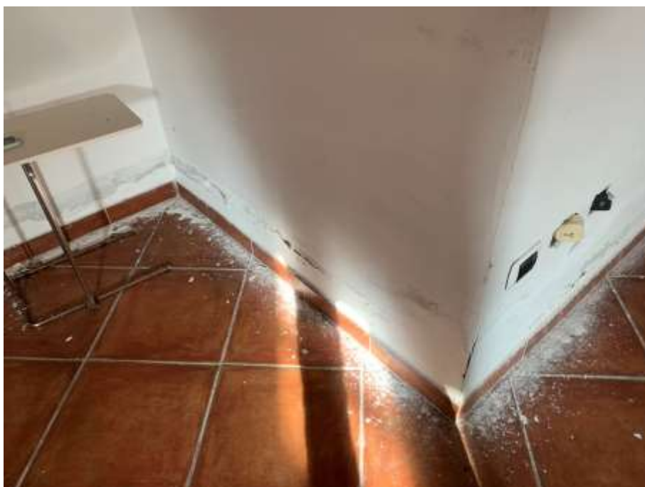
FOTO 17 – INTANCO AMMALORATO DA UMIDITA' DI RISALITA
