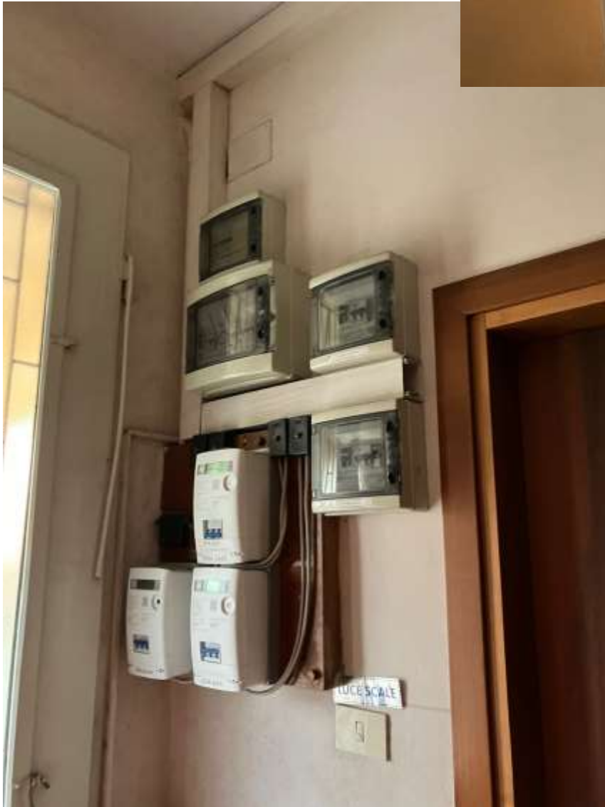
ZONA CONTATORI PIANO TERRA
