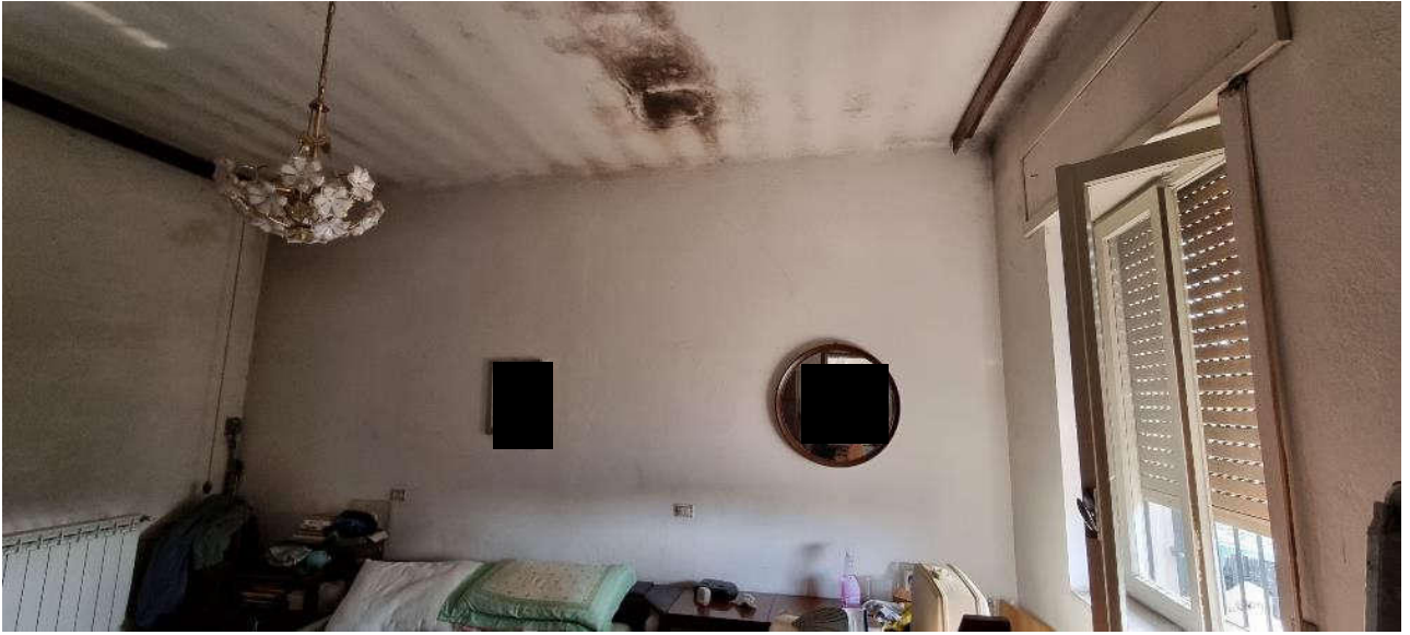
MACCHIE DI MUFFA SUL SOFFITTO CAMERA
