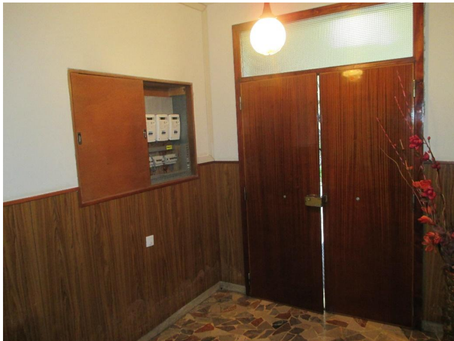
Foto n. 6b: Particolare dell'ingresso condominiale ripreso dall'interno. Sulla sinistra è visibile l'alloggiamento del misuratore dell'energia elettrica in comune con l'appartamento al piano primo (Bene A).
