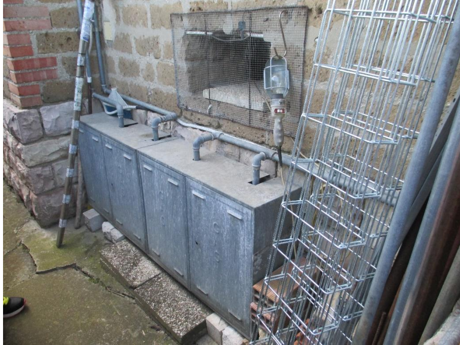
Foto n.7b: Particolare del misuratore gas metano posto all'esterno sul lato nord dell'edificio in comune l'appartamento al piano primo (Bene A).
