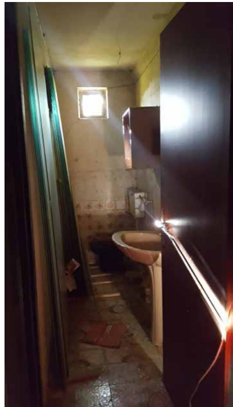
Foto N. 39: Wc del magazzino Lotto L4
