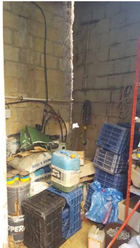
Foto N. 6: Parete in laterizio sconnessa del locale idrico da demolire Lotto L4
