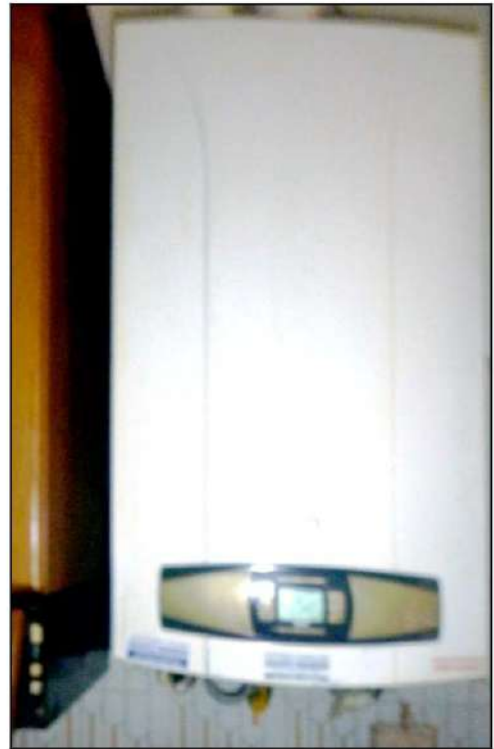
Foto 12 Vista dell'immobile – caldaia interna
