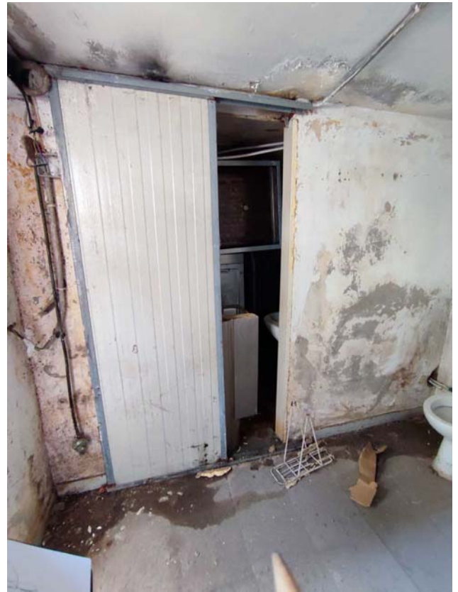
Foto 38. Porta verso Vano 2 inaccessibile (Sub.6)
