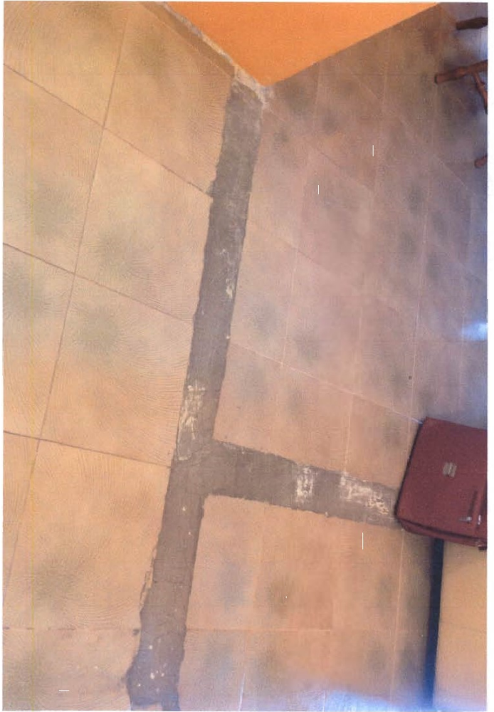
Foto 5 particolare della foto 4 (TRAVEZZO DEMOLITO)
