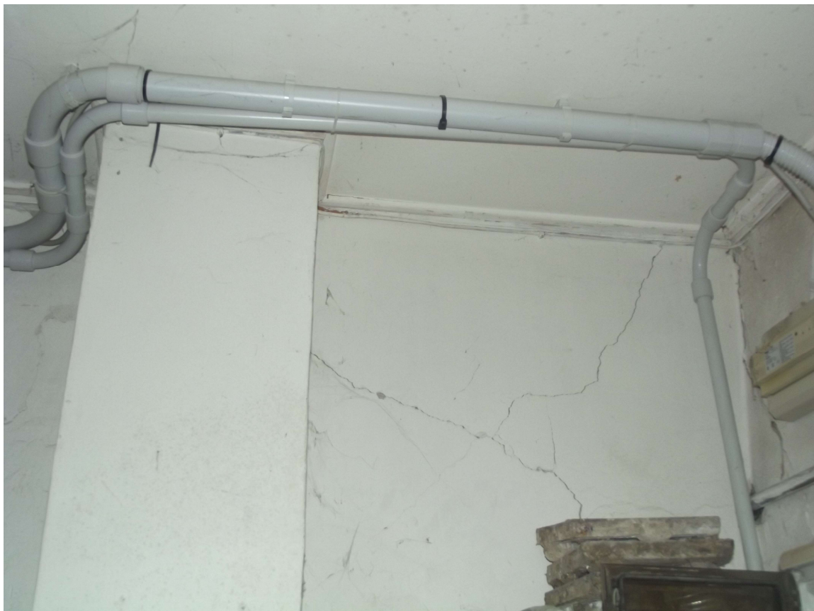
FOTO N°8: Edificio A vista Interna Piano Terra con lesioni (21.10.2016);
