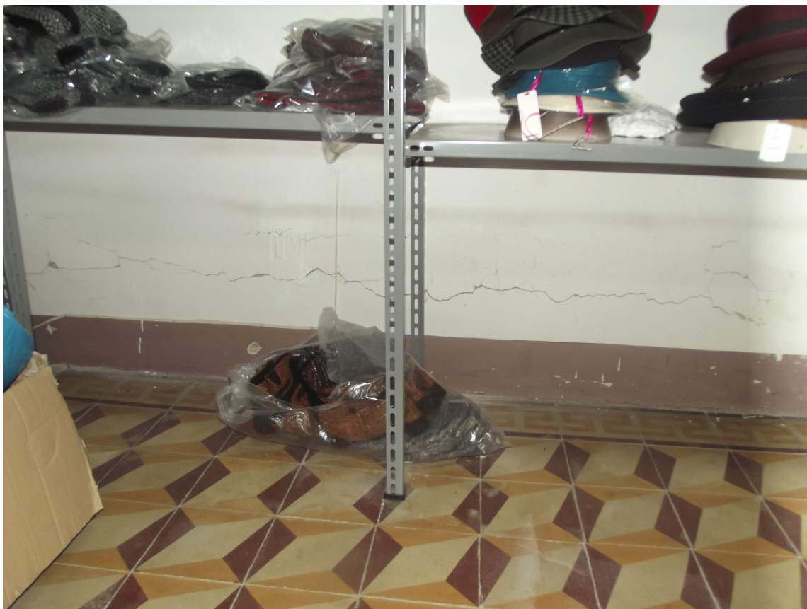
FOTO N°9: Edificio A vista Interna Piano Primo con lesioni (21.10.2016);
