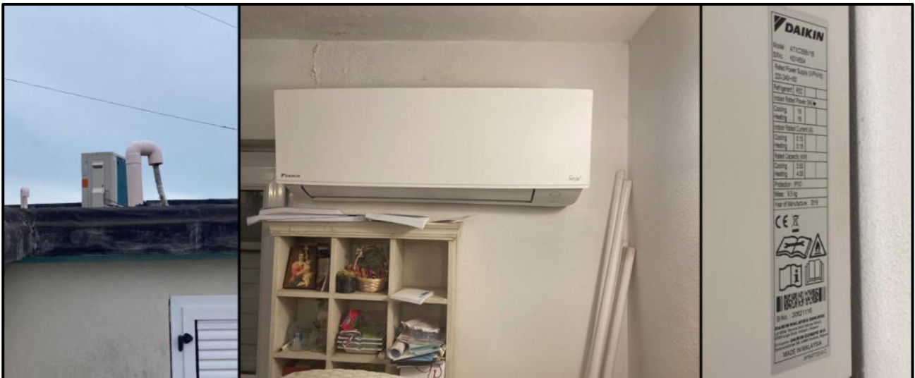
Impianto climatizzazione: pompa esterna sulla copertura, split interno, etichetta split
