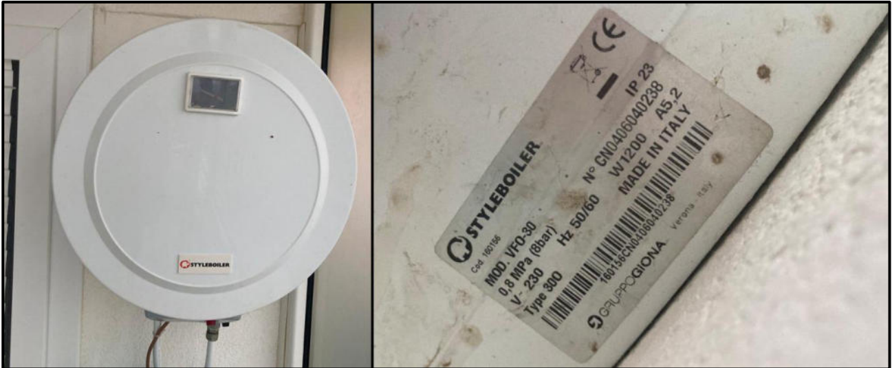
Impianto idrico: boiler elettrico per ACS posto nella terrazza
