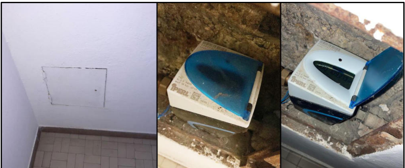
Impianto idrico: contatore nel vano scala
