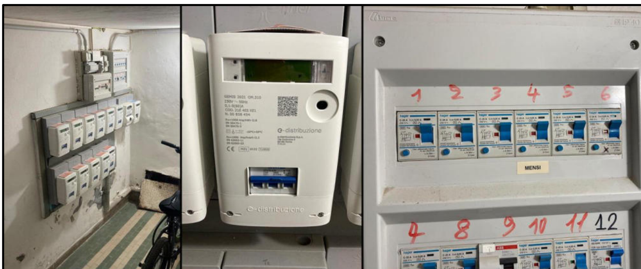
Impianto elettrico: punto di fornitura con contatori e differenziali.
