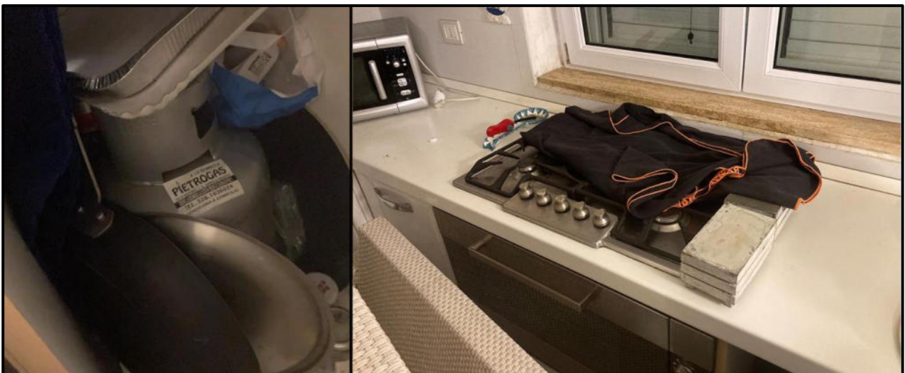
Impianto gas: piano cottura nella zona giorno e bombola gas GPL
