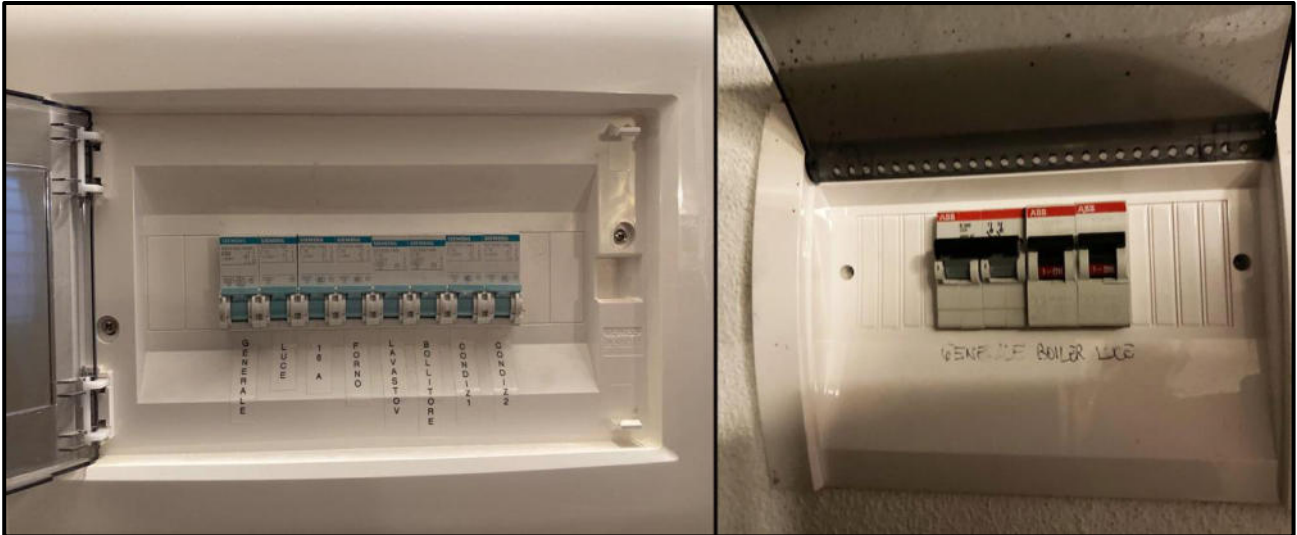
Impianto elettrico: quadro elettrico nell'immobile residenziale e nell'autorimessa
