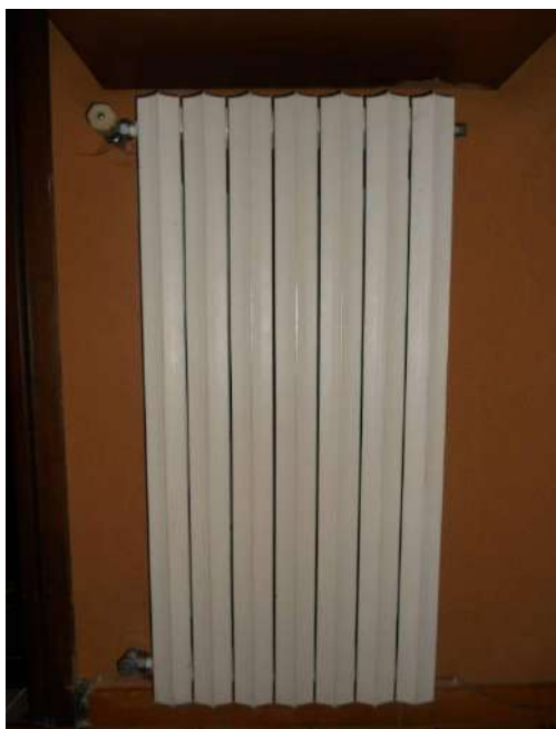
Foto 17 interno - Elementi radianti
