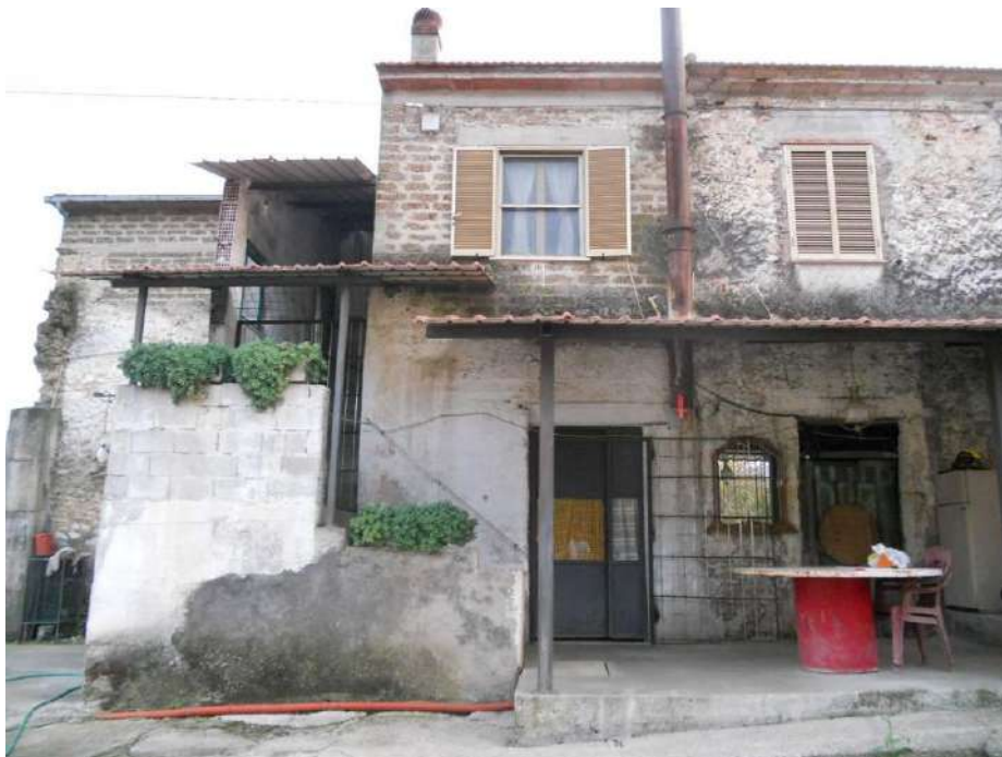
Foto 6 esterno - Scala e tettoia prospetto posteriore
