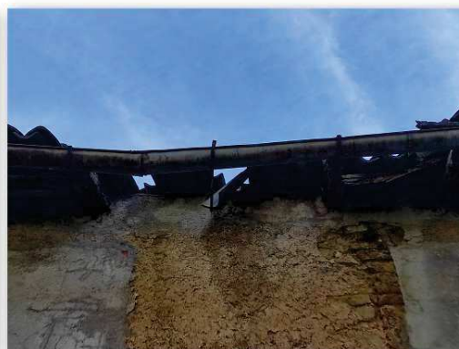
15. CORNICE E LATTONERIA PERICOLANTI
