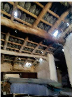
07. INFILTRAZIONI DAL TETTO
