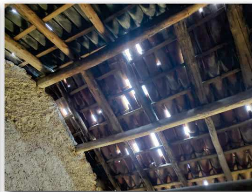
06. INFILTRAZIONI DAL TETTO
