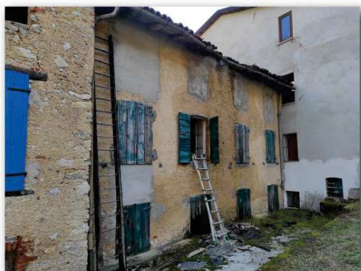
13. CADUTA DI COPPI SULLA CORTE DEL RETRO
