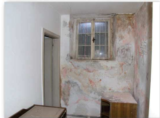
09. INFILTRAZIONI METEORICHE (RIPOSTIGLIO)
