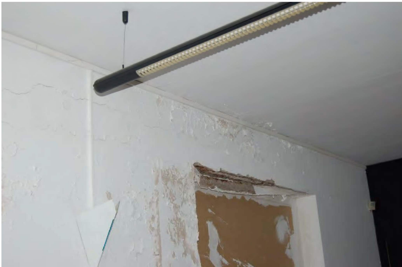
Foto 41 - Vista di dettaglio del degrado dell'ufficio posto al piano primo della zona espositiva A1
