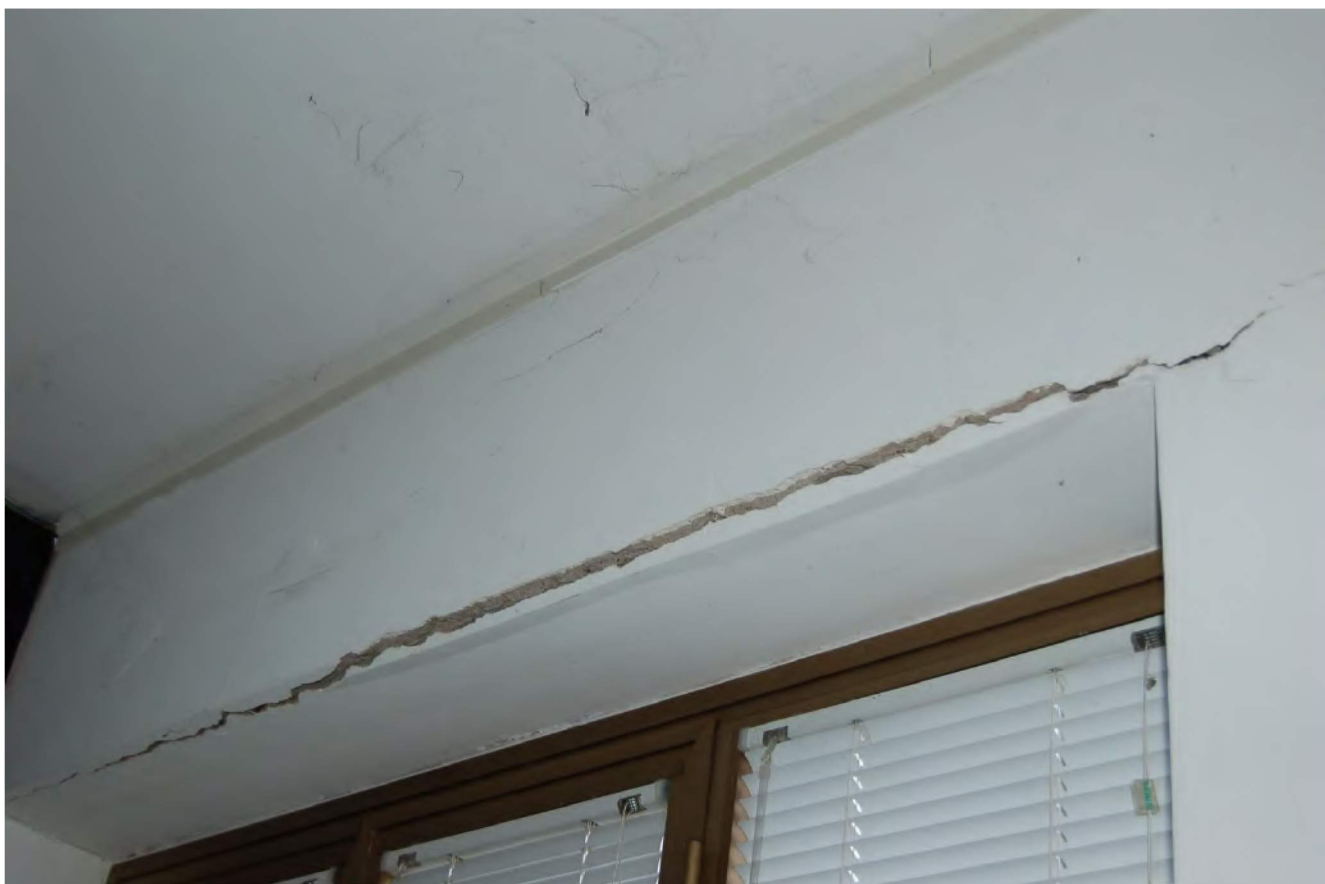
Foto 40 - Vista di dettaglio del degrado dell'ufficio posto al piano primo della zona espositiva A1
