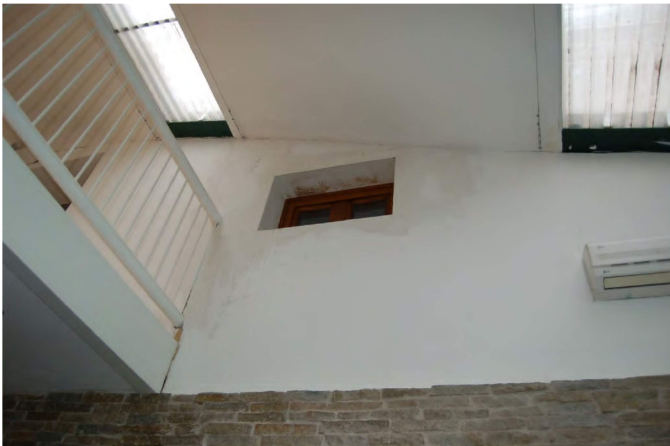
Foto 42 - Vista di dettaglio del degrado dell'ufficio posto al piano primo della zona espositiva A1
