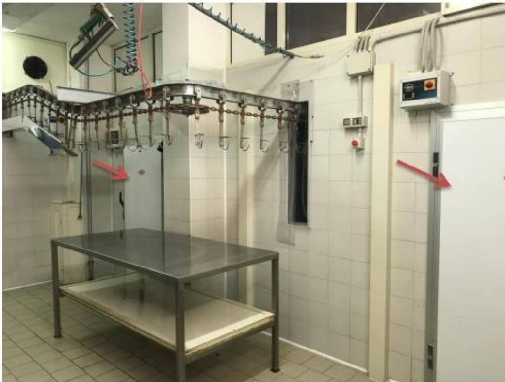
Vano 5 - Si evidenziano le due celle frigo
