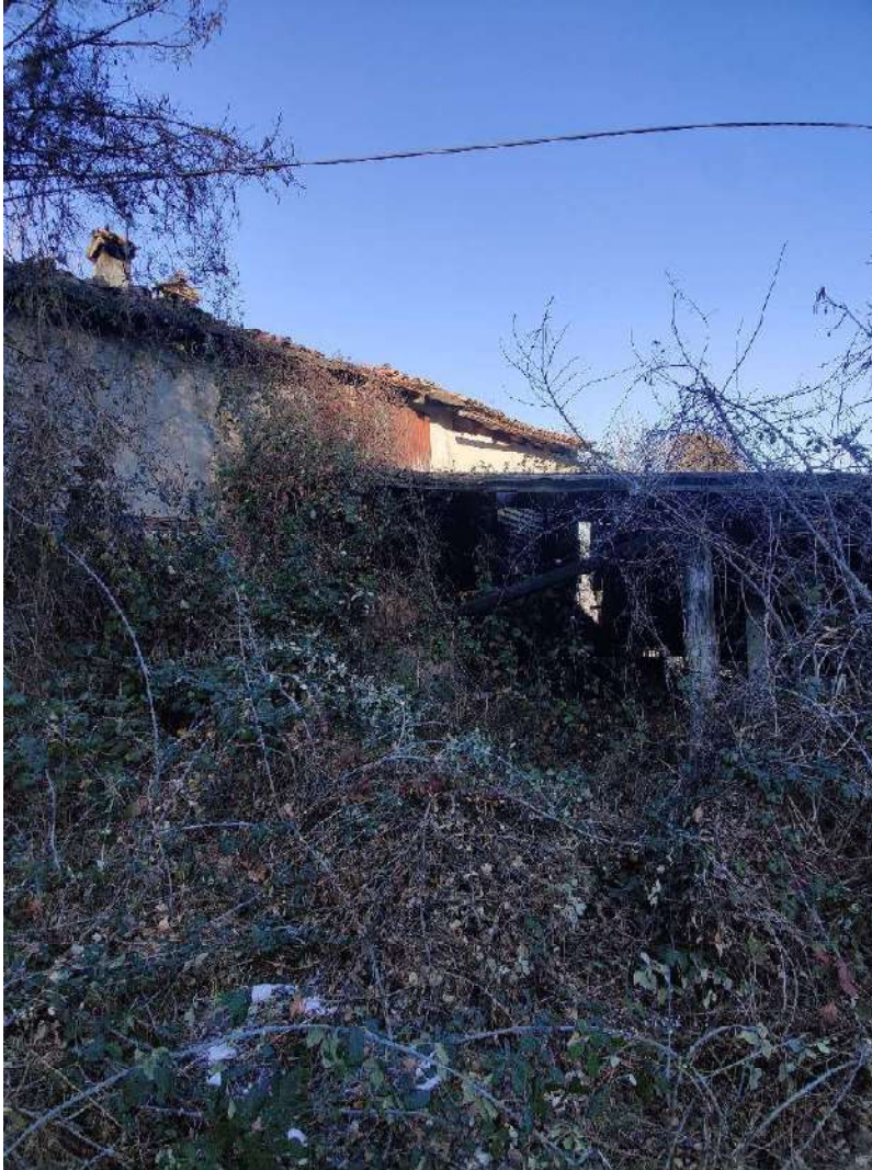
Vista esterna del fronte Est, coperto per buona parte da arbusti e sterpaglie. Sulla destra un fabbricato uso deposito in lamiera (abusivo).
