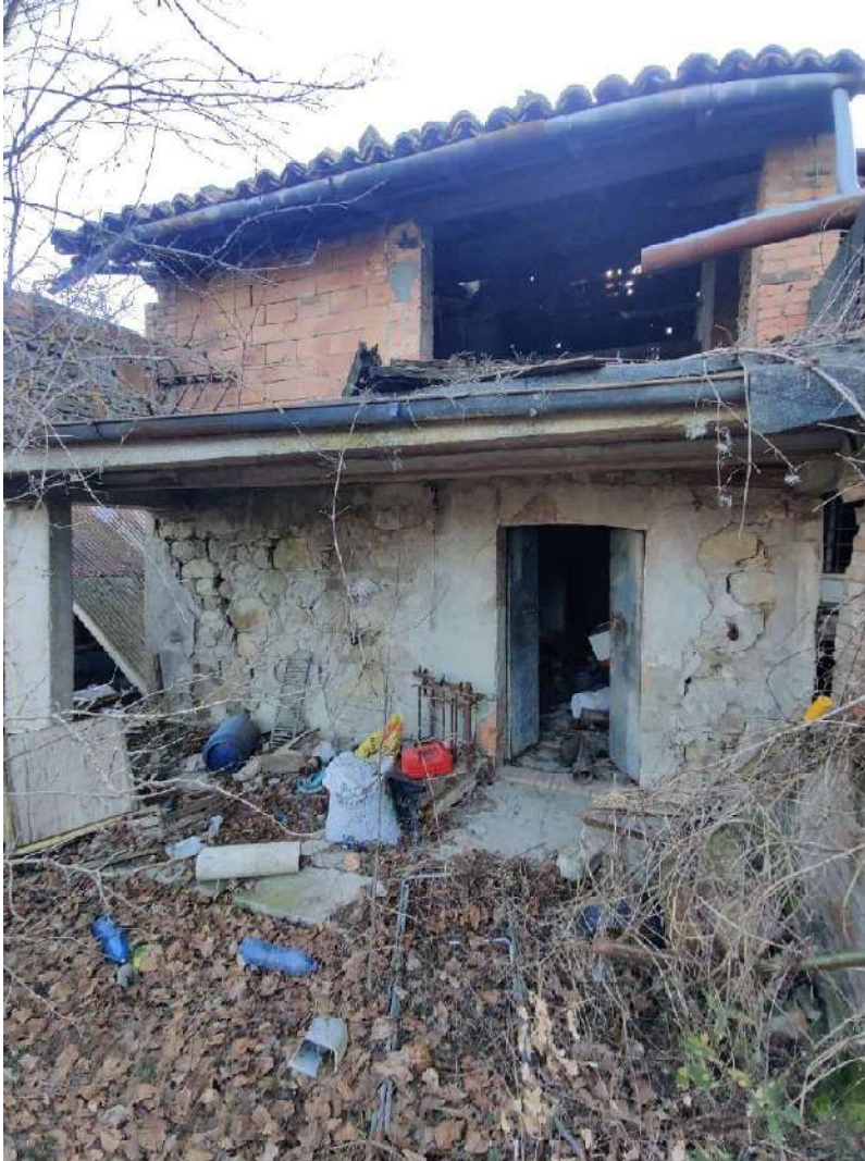
Vista esterna del fronte Ovest, particolare della legnaia al Piano Terra e del sottotetto al piano superiore. Dall'apertura nel sottotetto è visibile lo stato di danno e degrado della copertura lignea.
