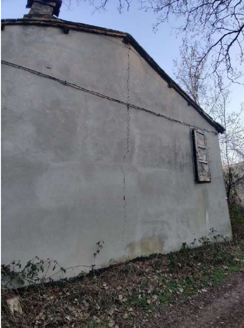
Immagine della lesione sul fronte Sud dell'edificio.
